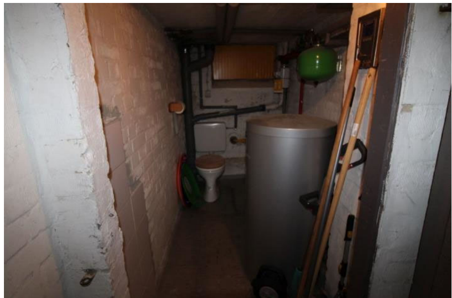
WC – Keller, Warmwasserspeicher.
