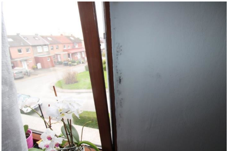
Schlafzimmer Fenster Zustand.
