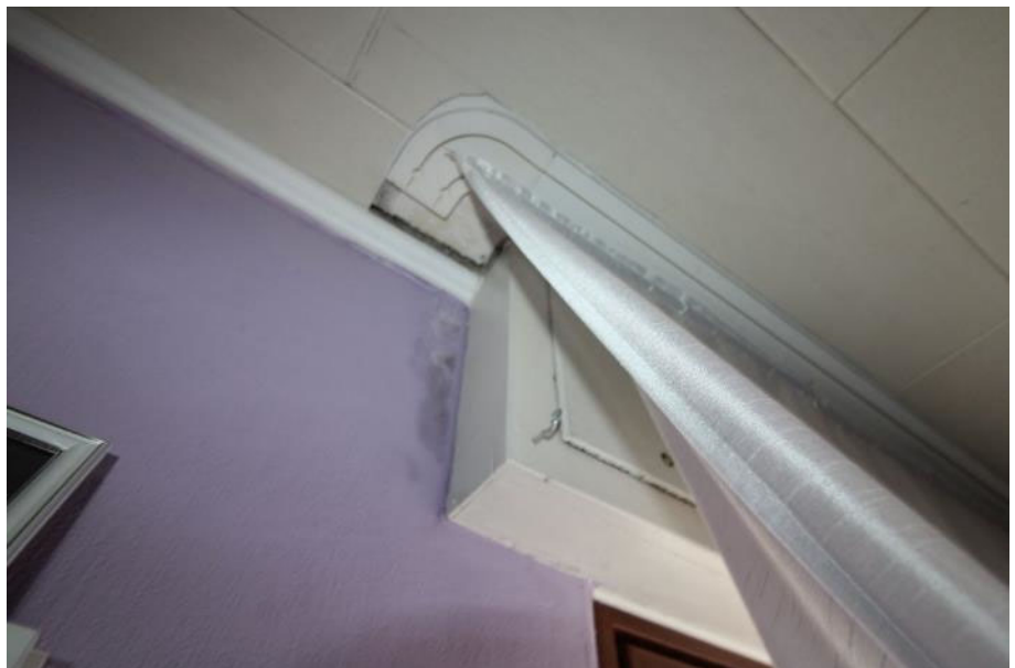
Kinderzimmer Fenster Zustand.
