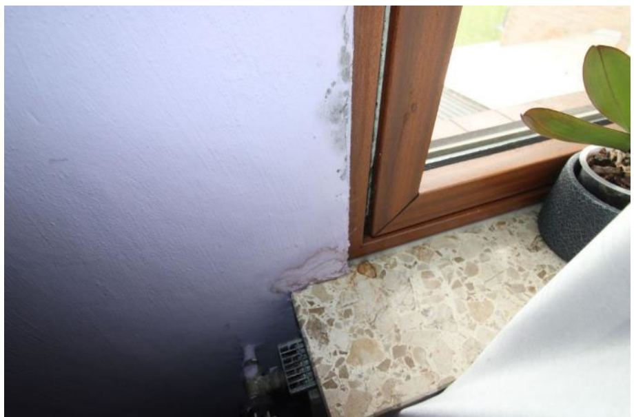
Kinderzimmer Fenster Zustand.
