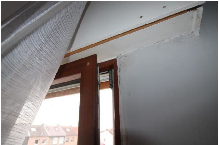
Schlafzimmer Fenster Zustand.
