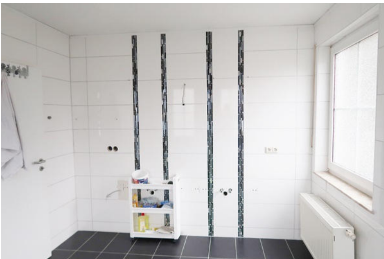
Bad im OG – fehlende Waschbecken.
