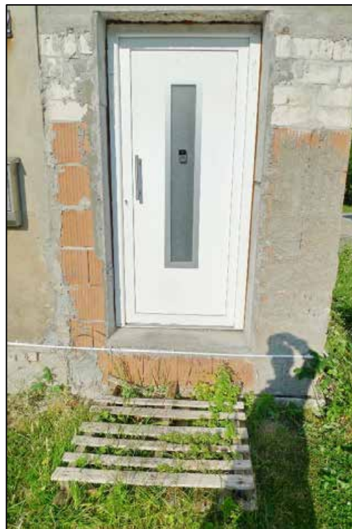
Abbildung 18 nicht abgeschlossene Arbeiten am Hauszugang (fehlender Differenzausgleich, keine Zuwegung – nur über Grünfläche) der Einfamilien-Doppelhaushälfte auf dem zu bewertenden Grundstück fotografiert am 13.08.2024
