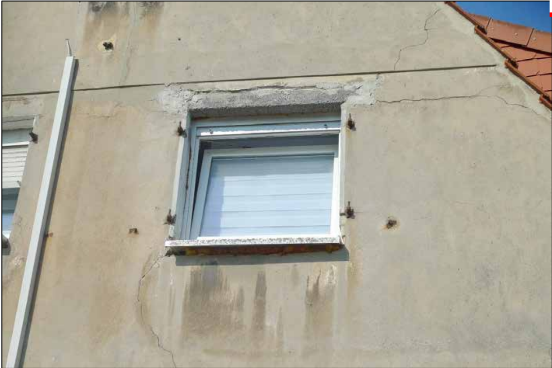
Abbildung 19 multiple Rissbildung an der Außenfassade der Einfamilien-Doppelhaushälfte auf dem zu bewertenden Grundstück fotografiert am 13.08.2024
