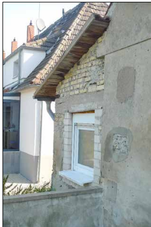
Abbildung 20 nicht abgeschlossene Putzarbeiten an der rückliegenden Giebelseite der Einfamilien-Doppelhaushälfte auf dem zu bewertenden Grundstück fotografiert am 13.08.2024
