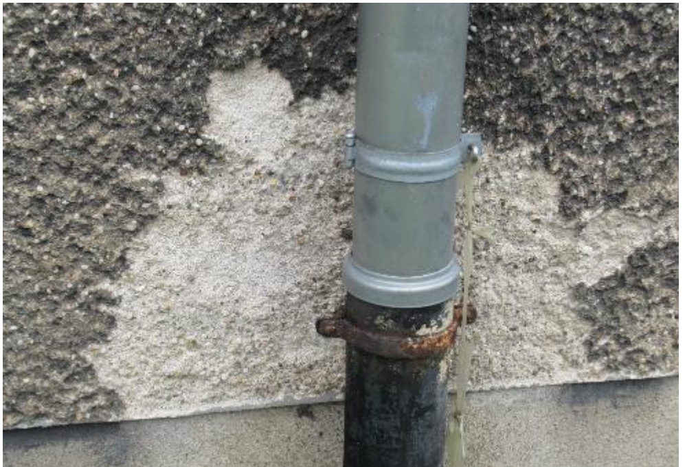
Putzschaden am Regenfallrohr
