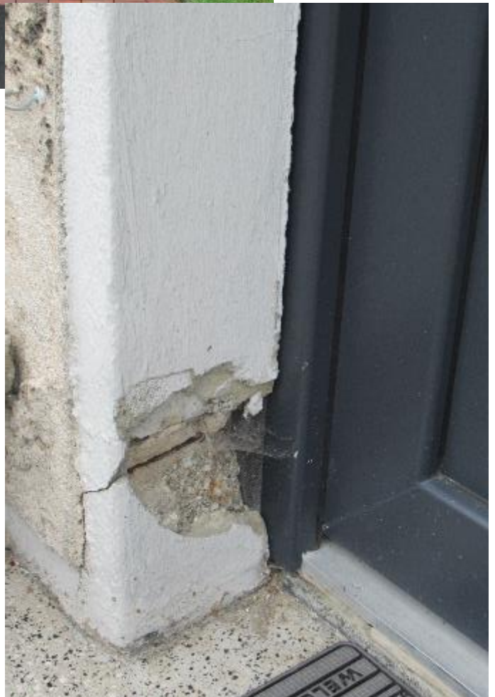
Putzausbruch im Haustürbereich
