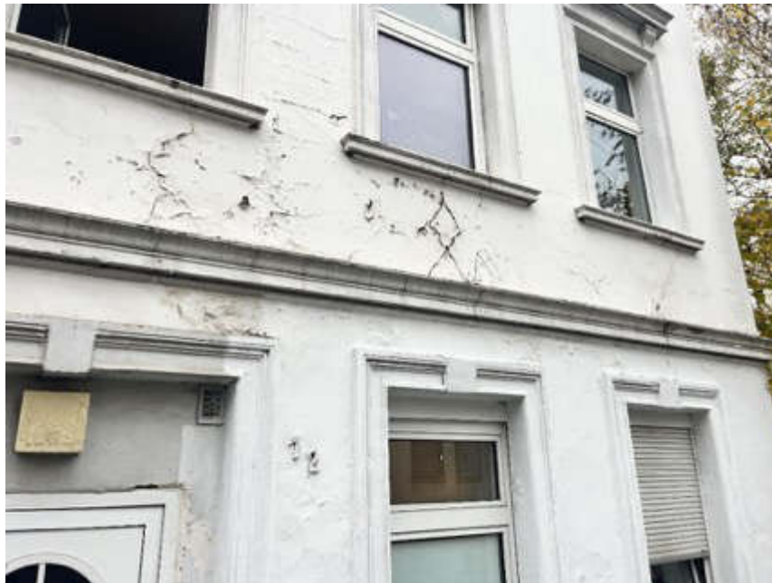
Bild 17: Schadensbild an der Fassade Haus Nr. 12
