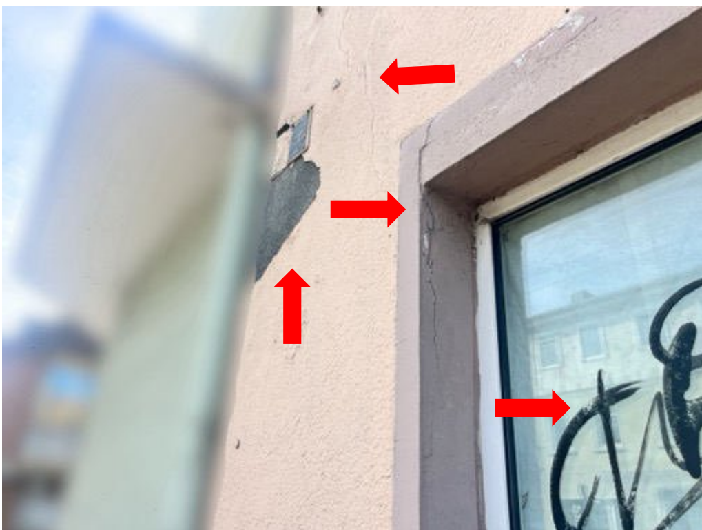
Rissbildung und Putzabplatzung an der Fassade /Graffiti am Schaufenster
