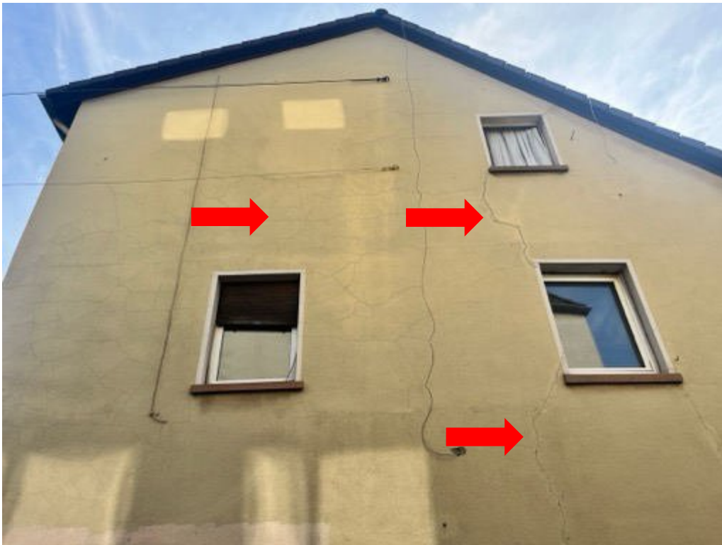
Rissbildung an der Giebelwand
