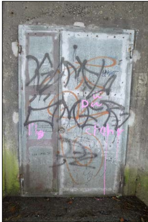
Abbildung 14 defekte Haupteingangstür vom Luftschutzbunker auf dem zu bewertenden Grundstück fotografiert am 29.05.2024
