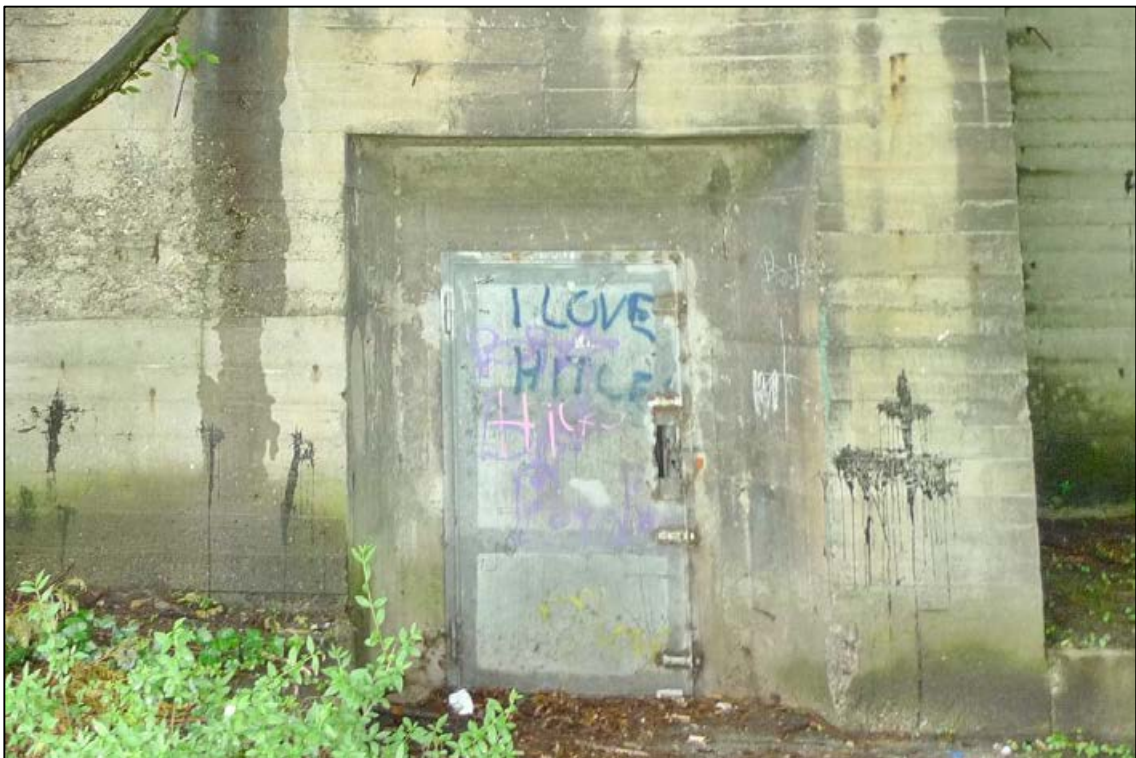
Abbildung 17 defekte Seiteneingangstür vom Luftschutzbunker auf dem zu bewertenden Grundstück fotografiert am 29.05.2024
