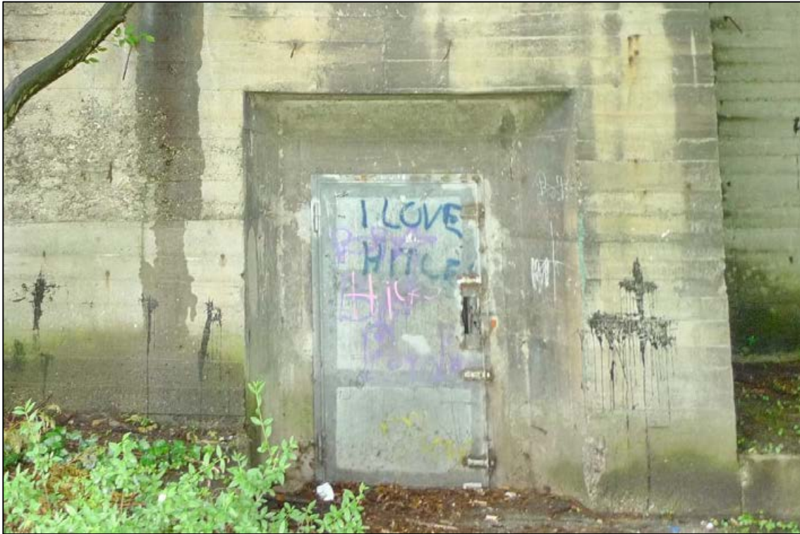
Abbildung 18 defekte Seiteneingangstür vom Luftschutzbunker auf dem zu bewertenden Grundstück fotografiert am 29.05.2024
