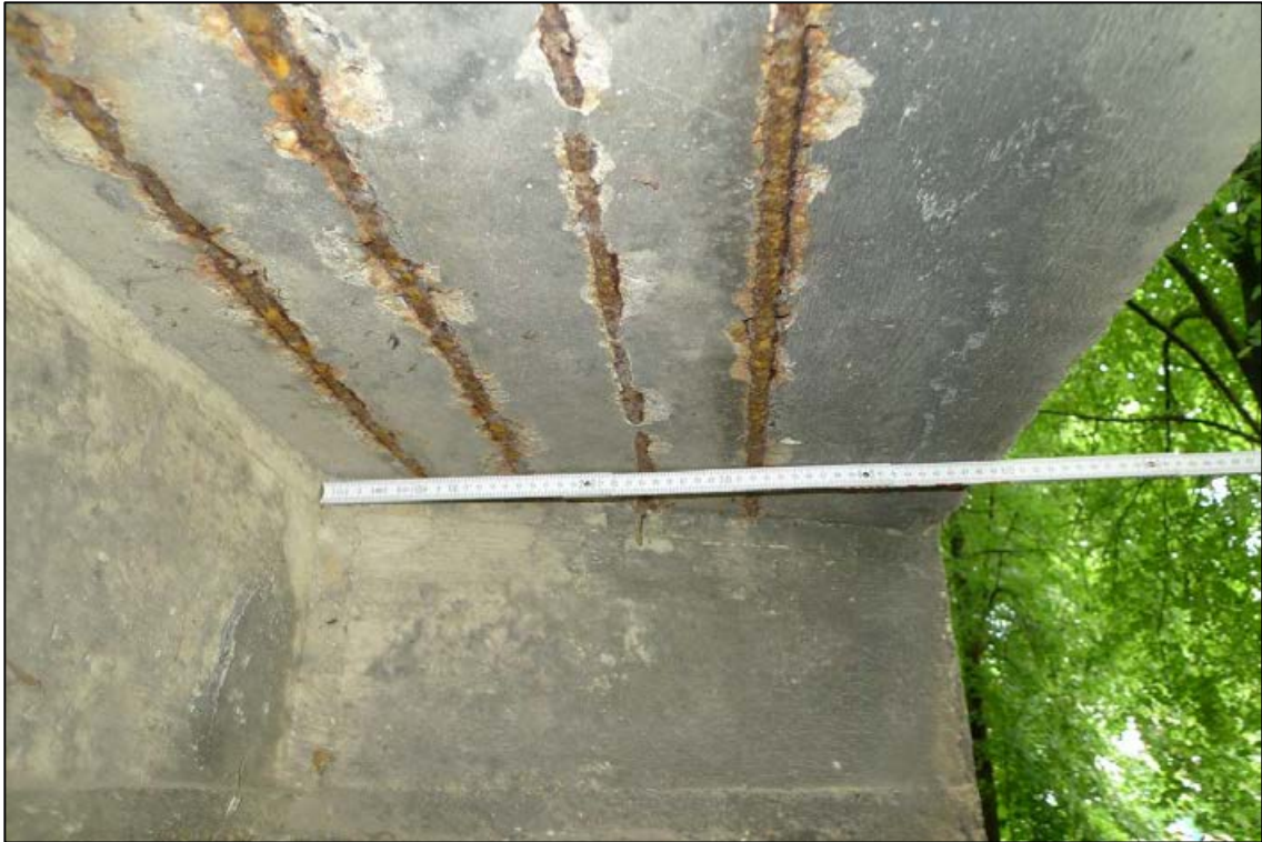
Abbildung 10 frei liegende Armierung an den Wänden vom Luftschutzbunker auf dem zu bewertenden Grundstück fotografiert am 29.05.2024
