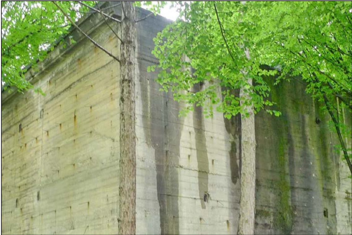
Abbildung 12 fehlendes Gesims sowie fehlende Dachrinnen und Fallrohre vom Luftschutzbunker auf dem zu bewertenden Grundstück fotografiert am 29.05.2024
