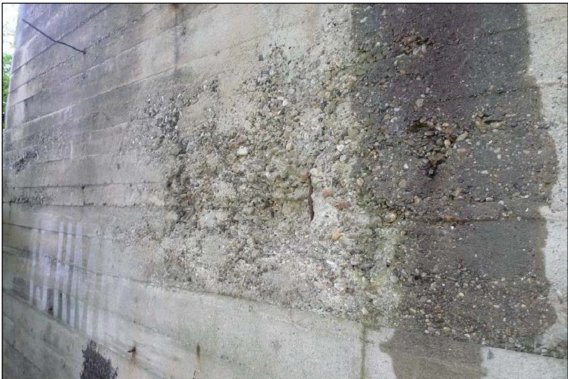
Abbildung 11 Betonschäden an den Wänden vom Luftschutzbunker auf dem zu bewertenden Grundstück fotografiert am 29.05.2024
