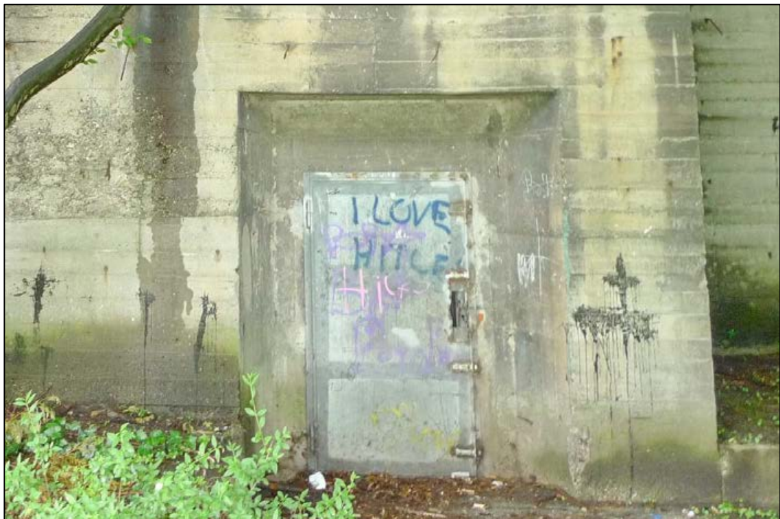
Abbildung 15 defekte Seiteneingangstür vom Luftschutzbunker auf dem zu bewertenden Grundstück fotografiert am 29.05.2024
