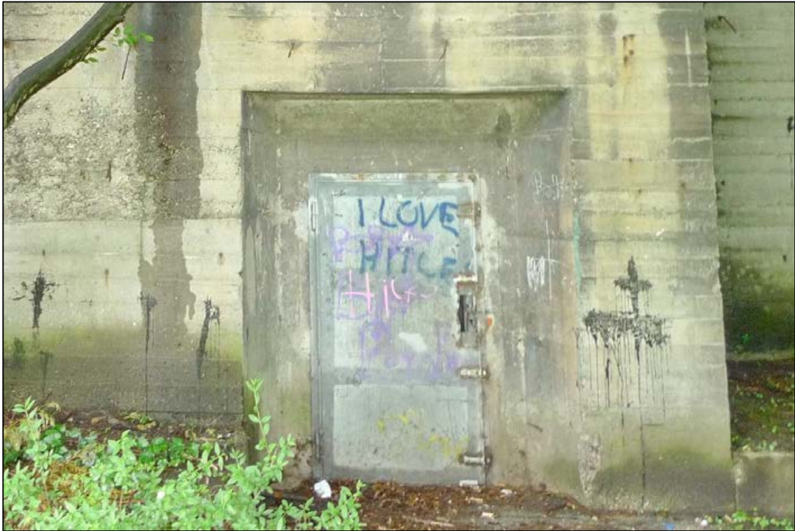
Abbildung 16 defekte Seiteneingangstür vom Luftschutzbunker auf dem zu bewertenden Grundstück fotografiert am 29.05.2024
