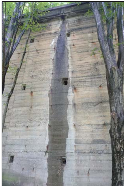
Abbildung 13 Betonschaden am Gesims vom Luftschutzbunker auf dem zu bewertenden Grundstück fotografiert am 29.05.2024
