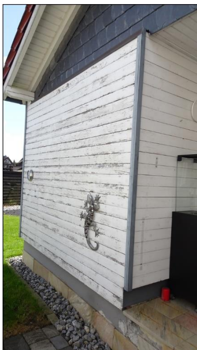
14) Fassade Nebengebäude/ Instandhaltungsrückstand Anstrich
