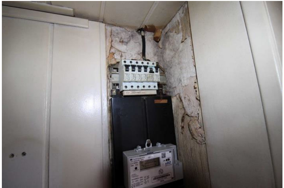
Sicht auf die Sicherungen- und Zähler im Flur / EG
