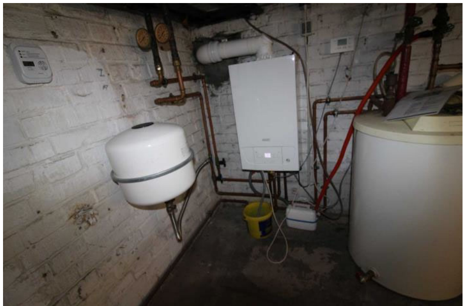
Sicht auf die Heizung in einem Kellerraum / KG
