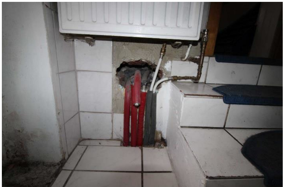
Sicht auf die Anschlüsse im Bereich des Zugangs zum Flur im Haupthaus / EG
