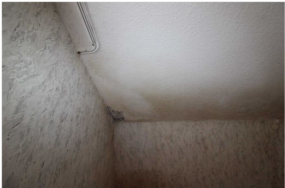
Sicht in den Raum 2 mit Feuchtigkeitsschä- den / DG
