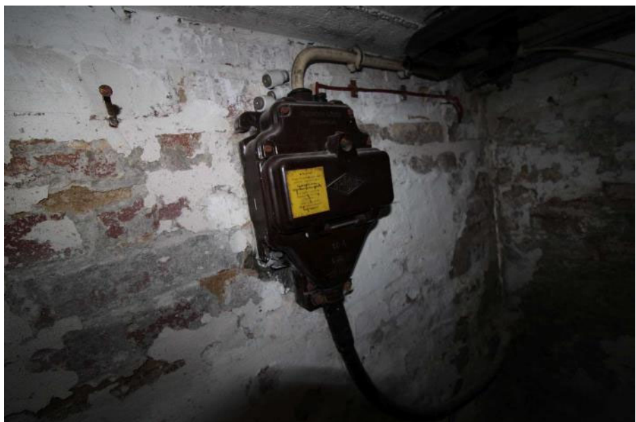
Sicht auf die Hausanschlüsse in einem Kellerraum / KG
