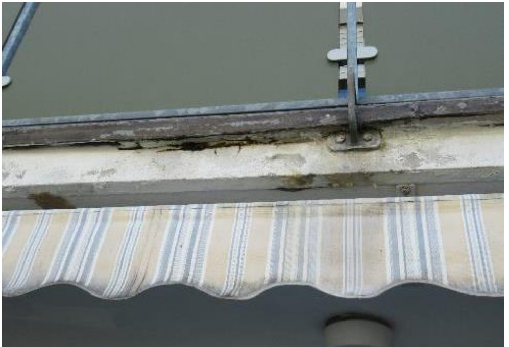
Schäden an der Balkonplatte
