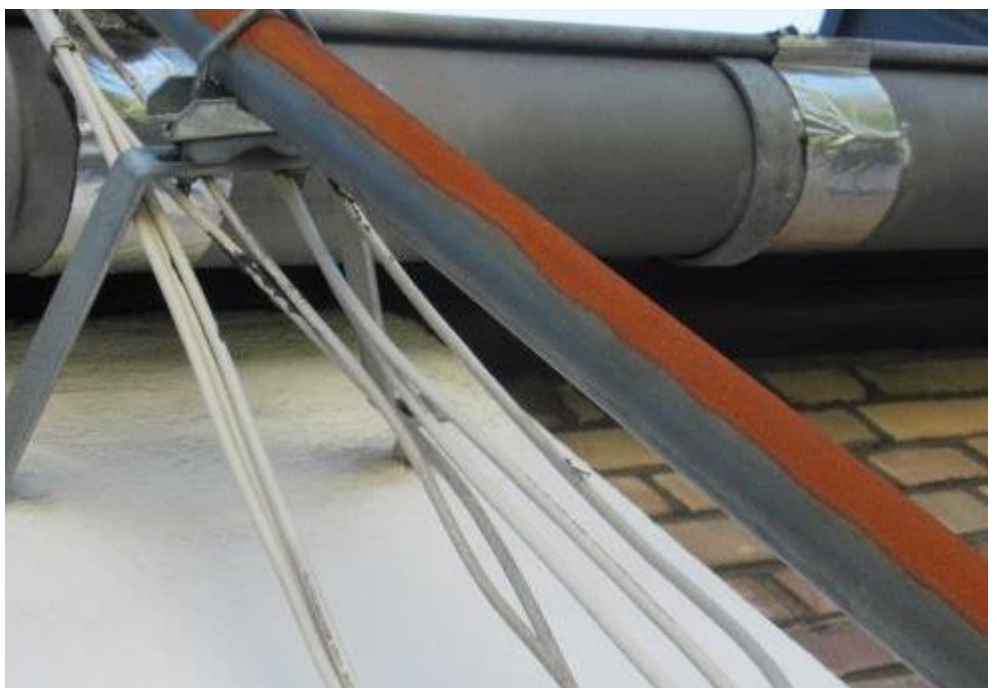
Schäden an der Dachrinne
