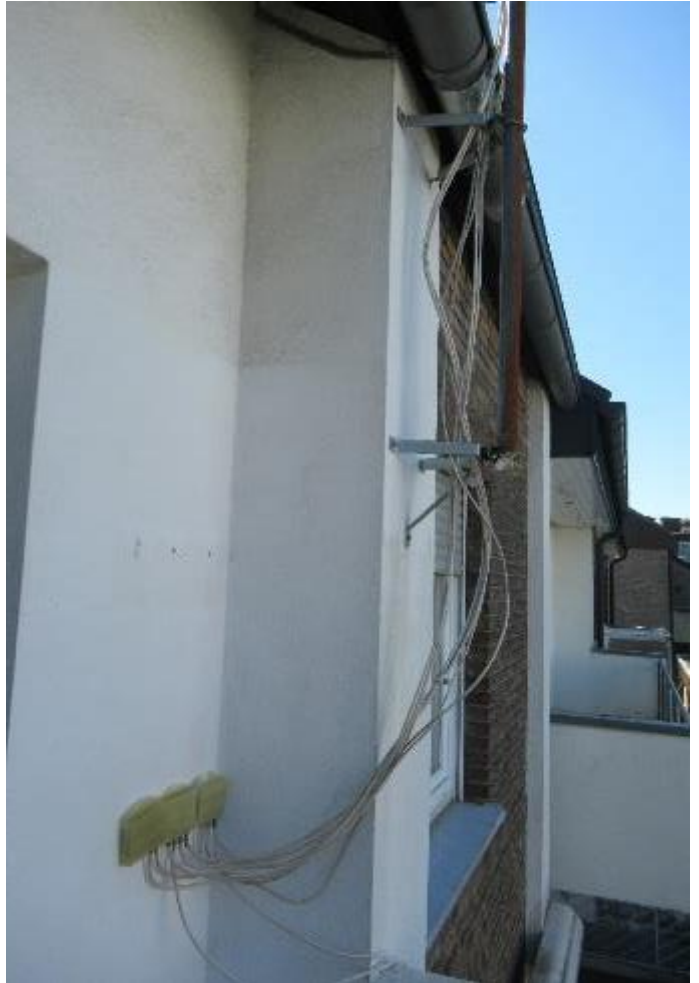
Kabel zur SAT-Anlage
