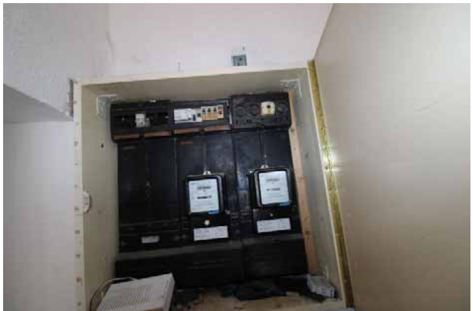
Sicht auf einen Zählerkasten im Treppenhaus / EG
