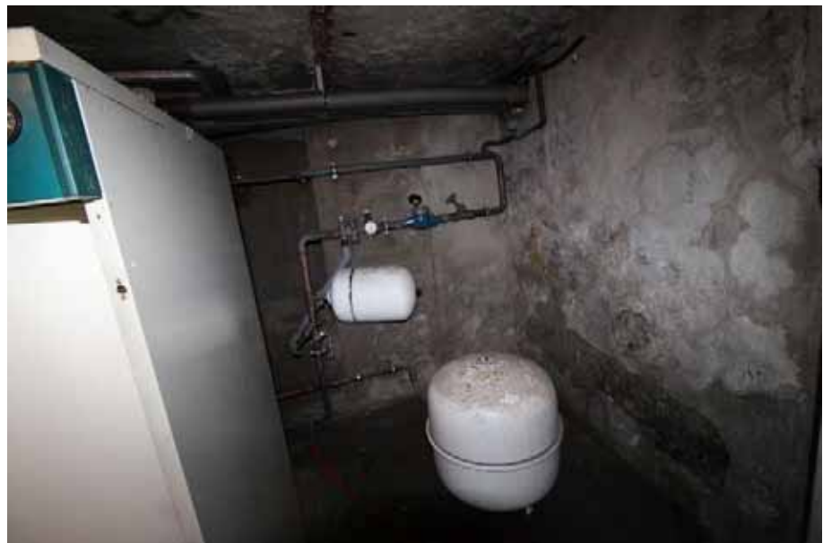
Sicht auf die Heizung / KG
