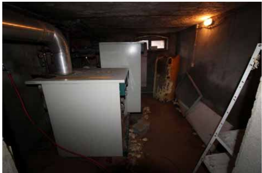
Sicht auf die Heizung / KG
