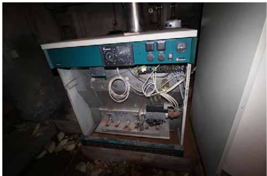
Sicht auf die Heizung / KG
