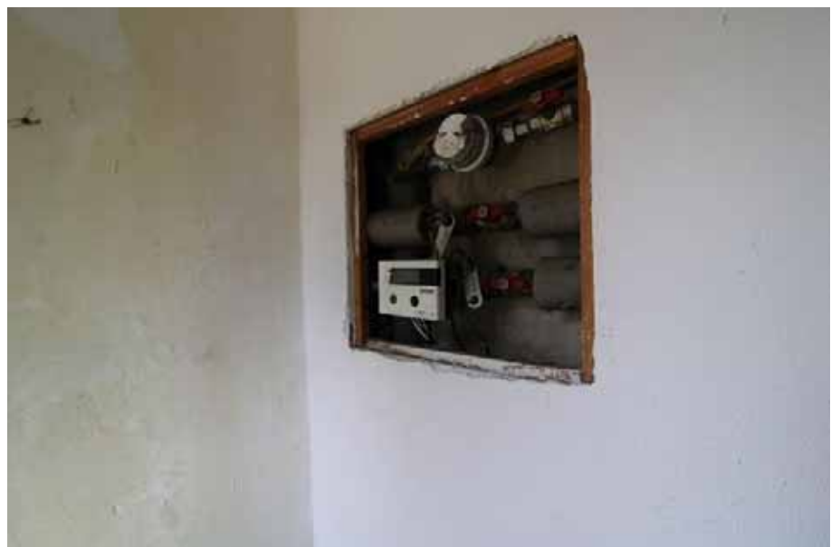
Sicht auf die Zähler / EG
