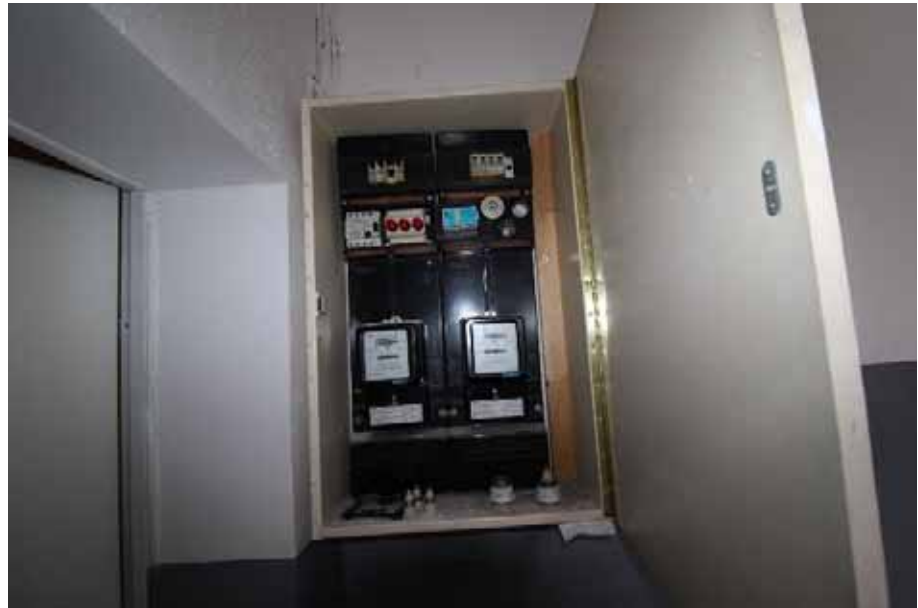
Sicht auf einen Zählerkasten im Treppenhaus / 2. OG
