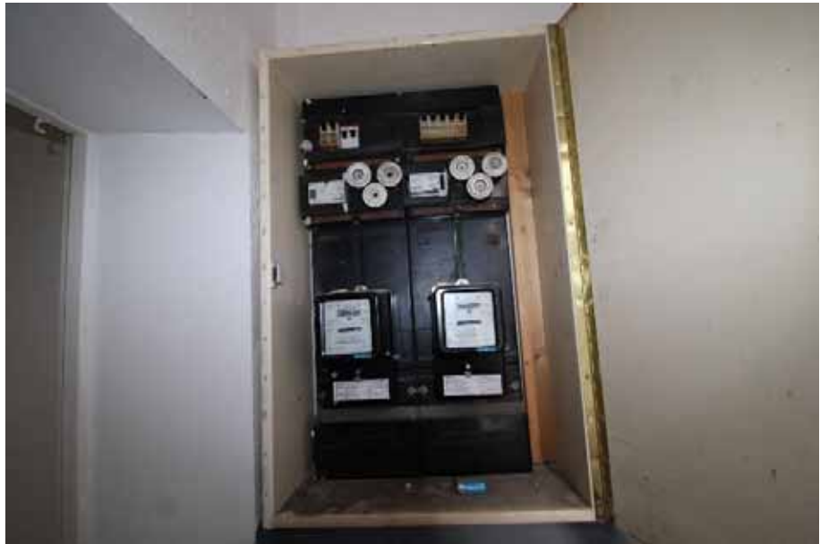
Sicht auf einen Zählerkasten im Treppenhaus / 1. OG
