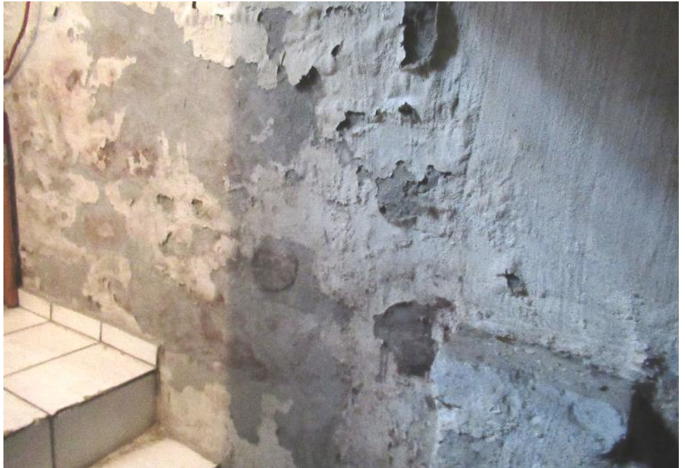
Durchfeuchtungen / Putzabplatzungen im Keller
