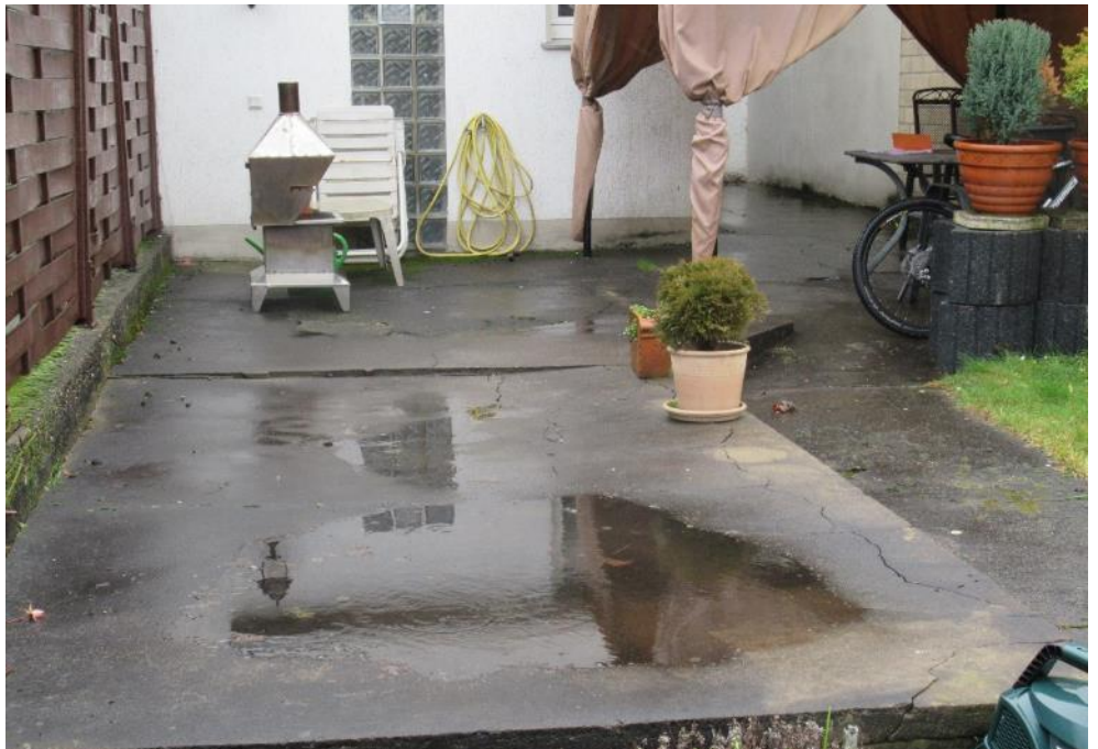
Risse in der Terrasse
