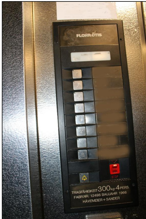
Foto Nr. 13: Forellstraße 61, Aufzugsanlage
