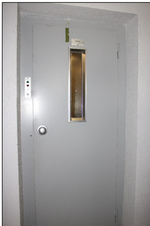
Foto Nr. 14: Forellstraße 61, Aufzugsanlage
