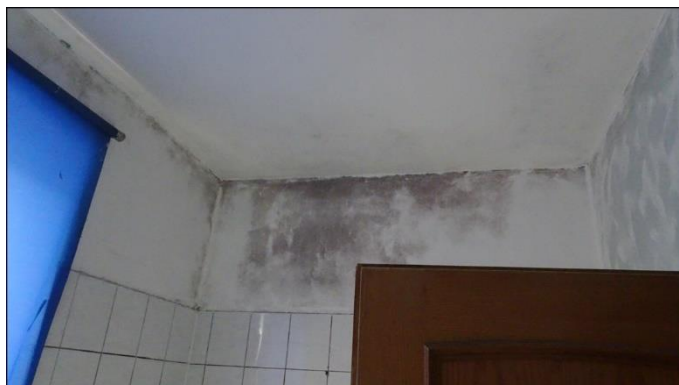
24) Dachgeschoss Haupthaus/ Schäden Bad
