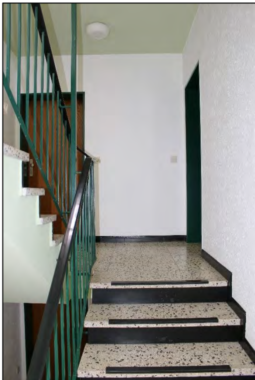
Foto Nr. 10: Langenbochumer Straße 453, Gemeinschaftstreppe
