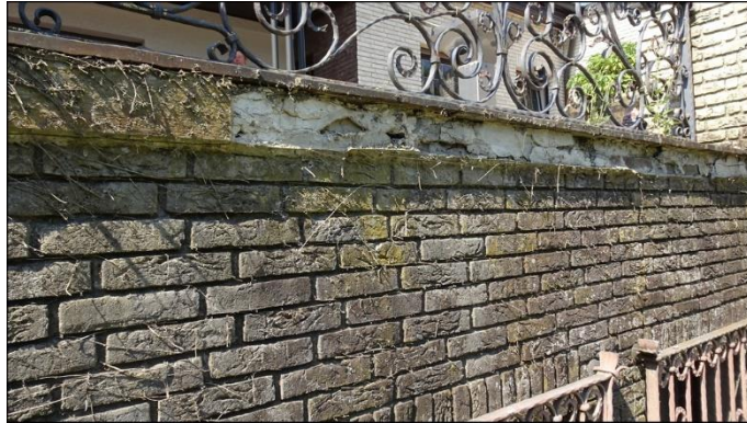
7) Detailfoto Schäden an der unterkellerten Terrasse
