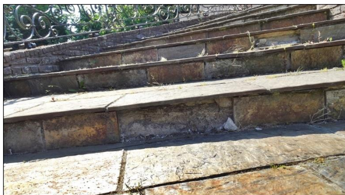
6) Detailfoto Schäden an der Treppenanlage
