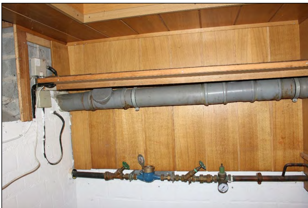
Foto Nr. 22: Kellergeschoss, Hausanschlussraum
