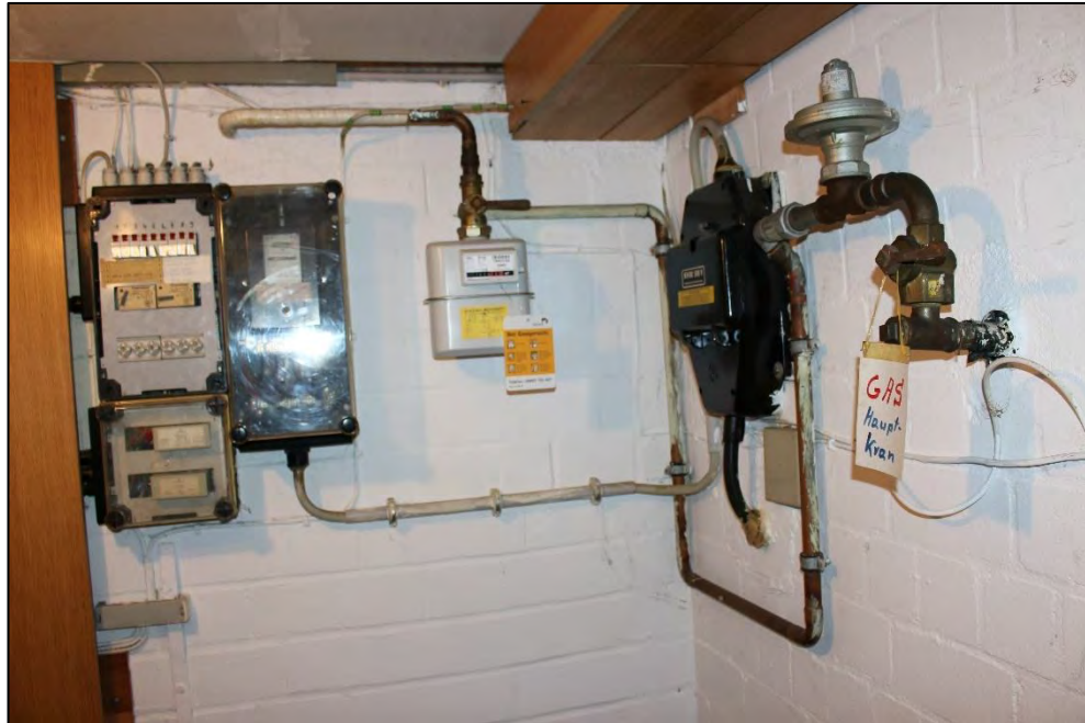
Foto Nr. 23: Kellergeschoss, Hausanschlussraum
