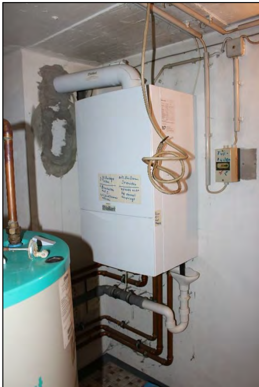
Foto Nr. 19: Kellergeschoss, Heizungsraum
