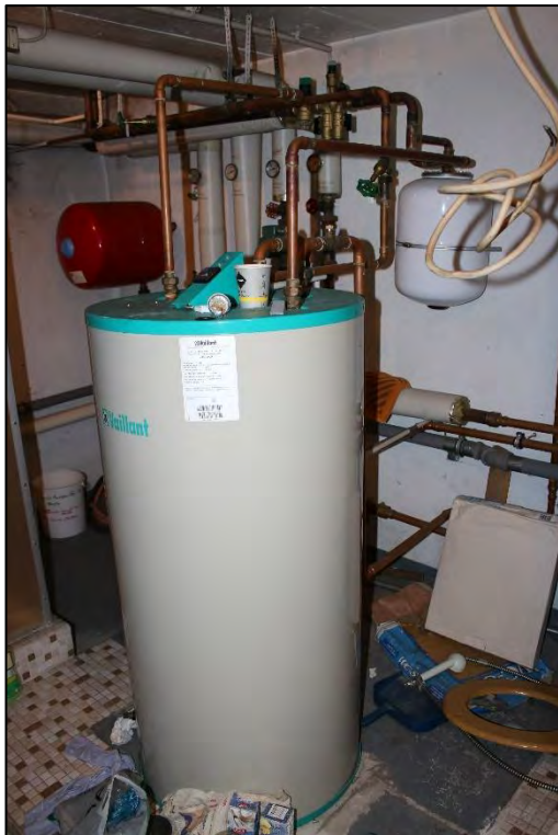
Foto Nr. 17: Kellergeschoss, Heizungsraum
