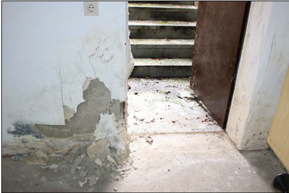
Foto Nr. 27: Kellergeschoss, Kelleraußeneingang / Feuchteschäden
