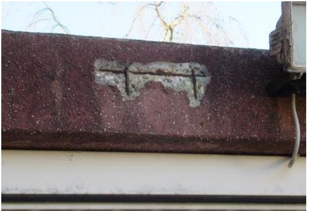
Schäden an der Fassade
