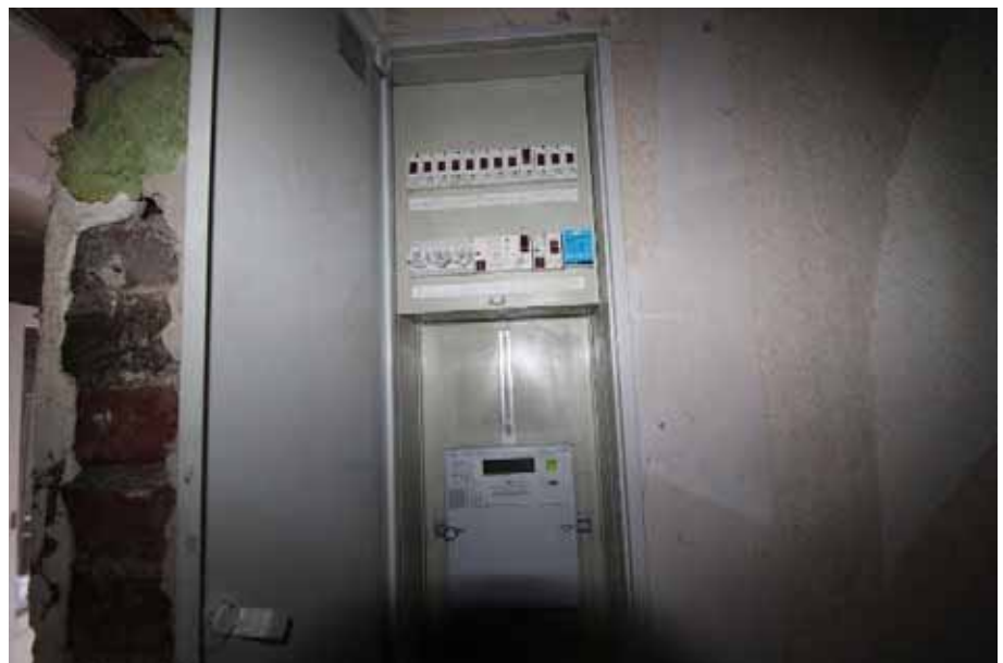
Sicht auf die Elektro- unterverteilung / EG
