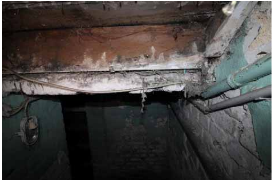
Sicht auf Feuchteschäden am Holztrep- penlauf / KG
