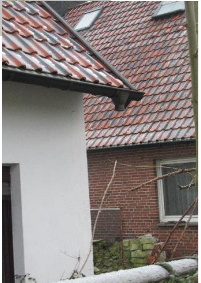
Fehlendes Fallrohr am Taubenhaus
