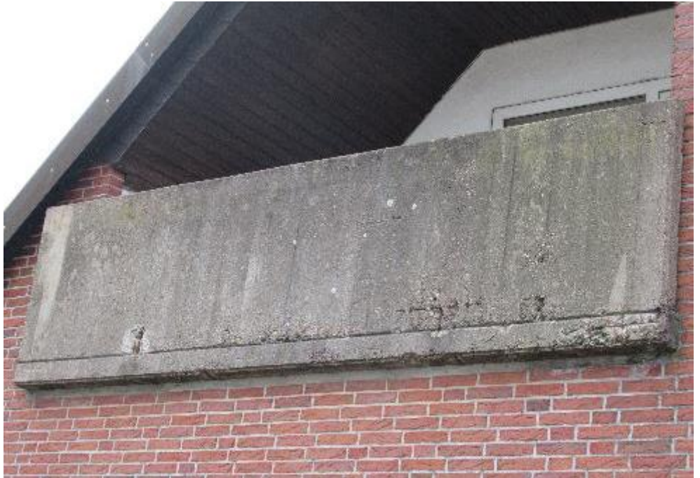
Brüstung der Loggia (Betonausbrüche / korrodierte Eisen)
