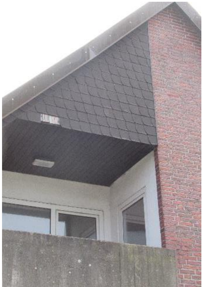
Fehlende Zementfaserplatten an der Giebelseite
