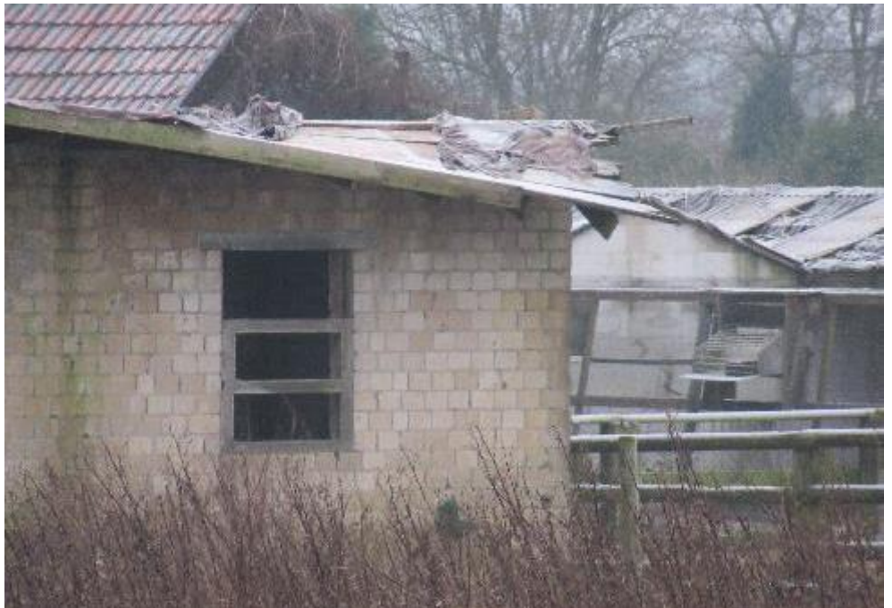
marode Dachhaut am Pferdestall
