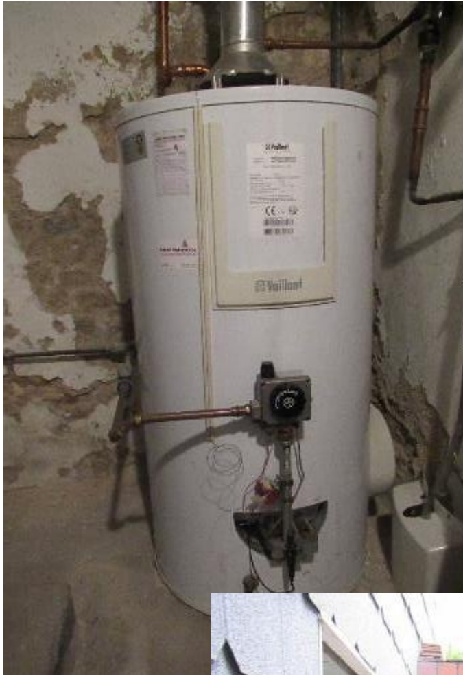
Brauchwasser- speicher / Durchfeuchtungen und Putzabplatzungen
