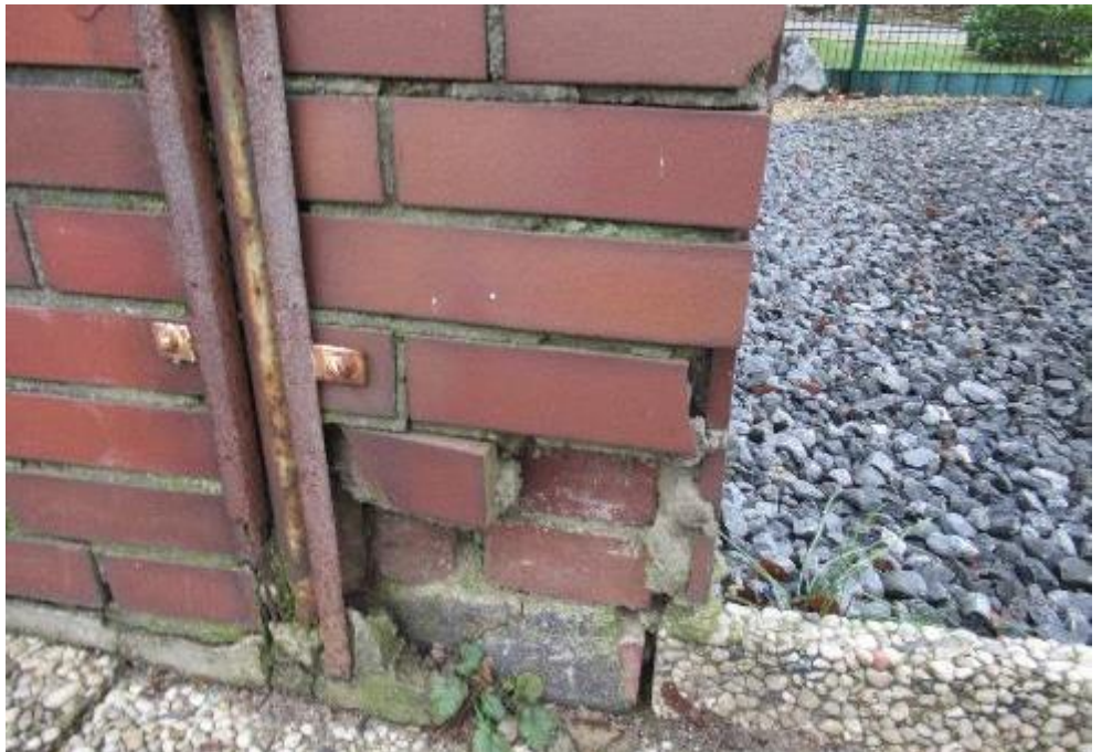
Schäden an der Straßenfassade
