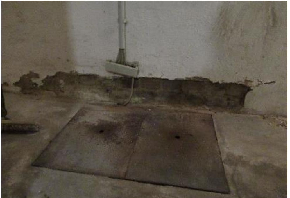
Durchfeuchtungen / Putzabplatzungen im Flurbereich
