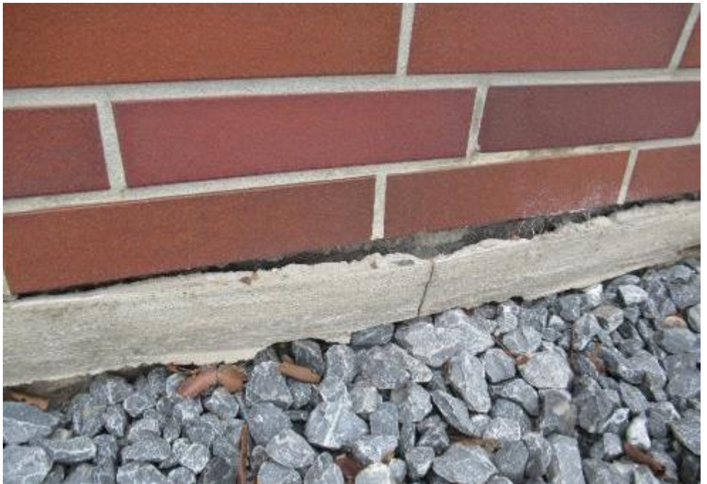
Putzschaden an der Straßenfassade
