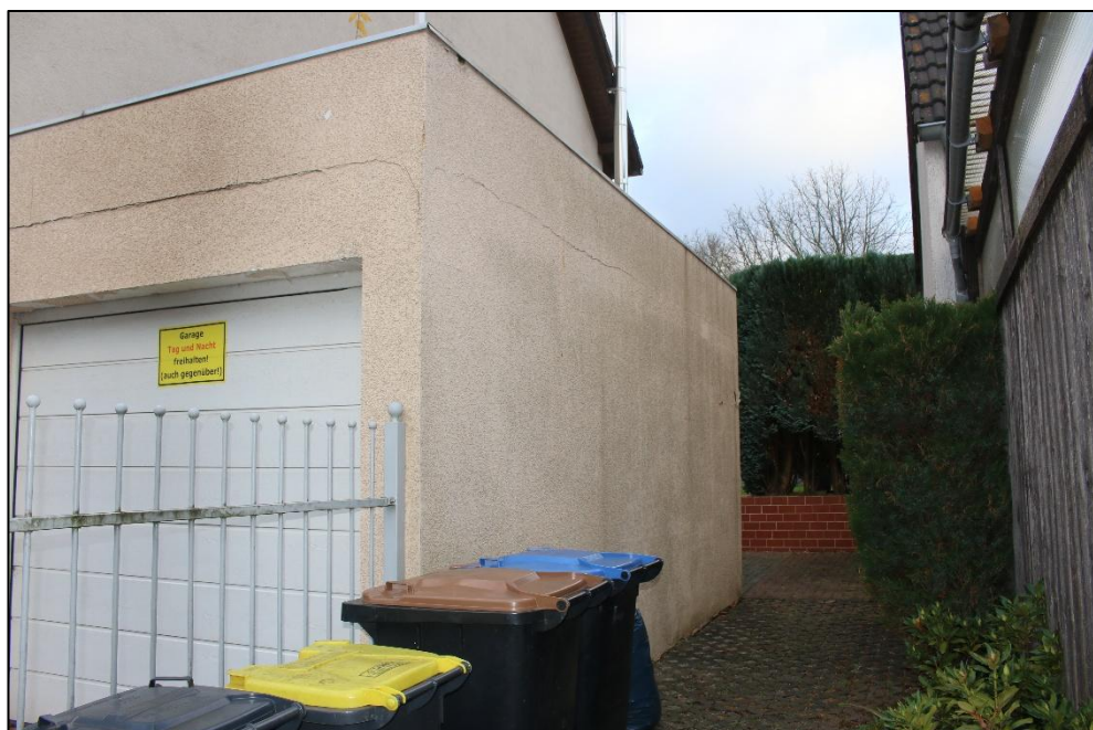
Foto Nr. 10: Garage, Ehlingstraße 57, Rissbildung Fassade
