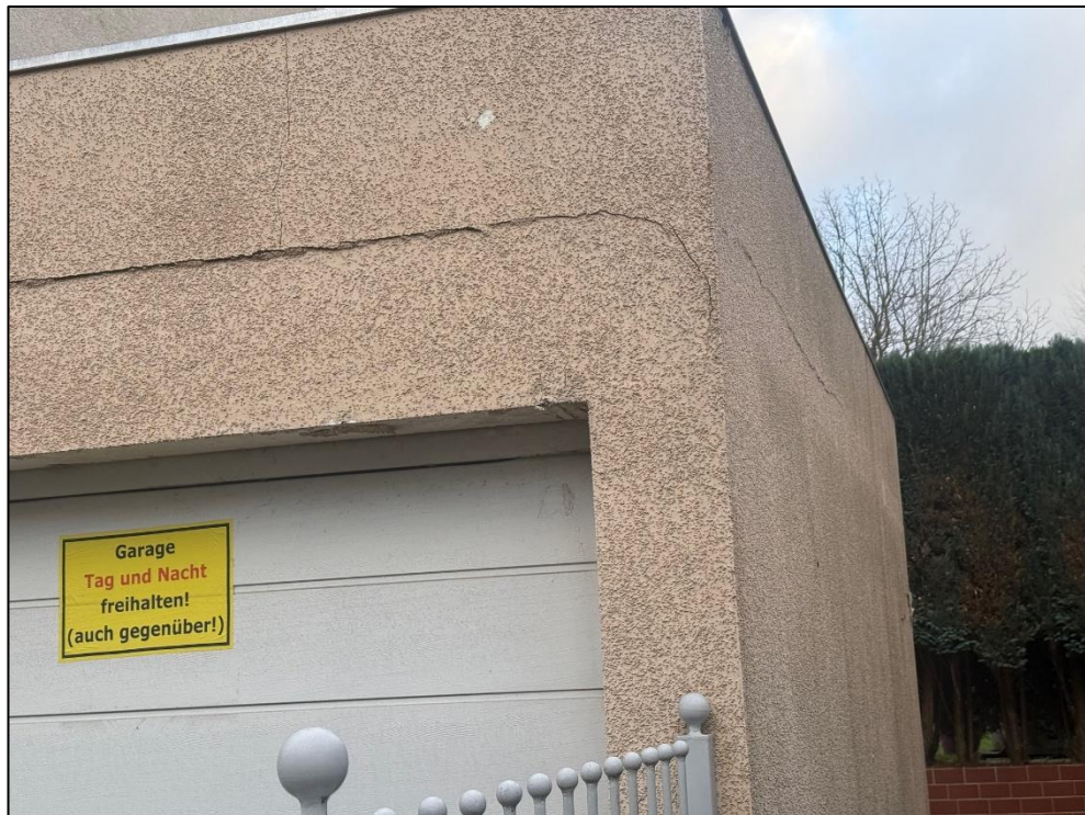
Foto Nr. 11: Garage, Ehlingstraße 57, Rissbildung Fassade
