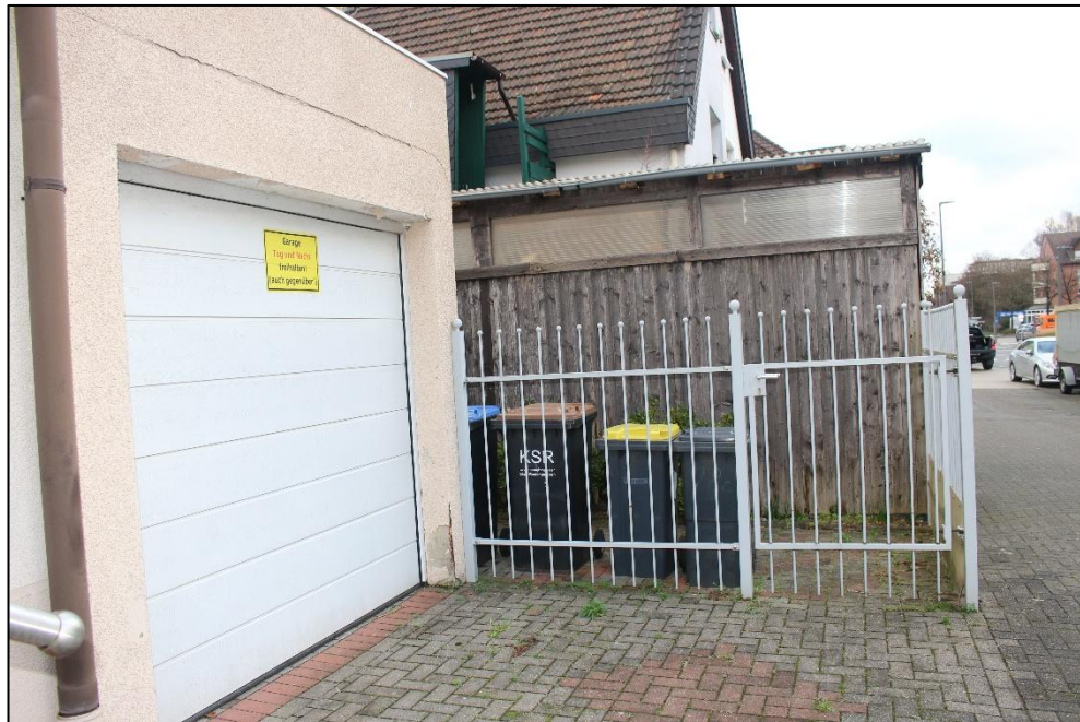
Foto Nr. 9: Garage, Ehlinstraße 57, Rissbildung Fassade
