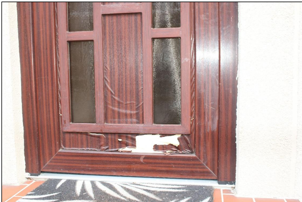
Foto Nr. 8: Doppelhaushälfte links, Ehlingstraße 55, Schaden Haustür
