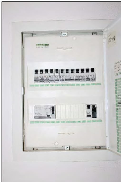
Foto Nr. 33: 1. OG, WE Nr. 2, Diele / Elektrounterverteilung
