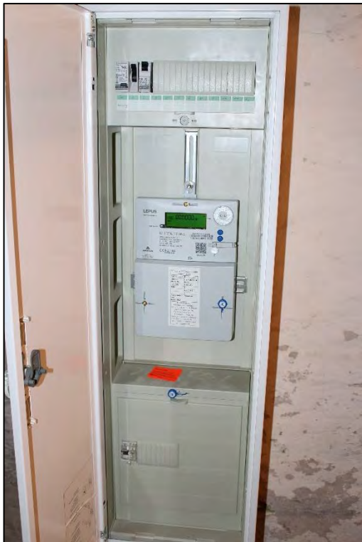
Foto Nr. 11: Kellergeschoss, Elektrounterverteilung / Zähler
