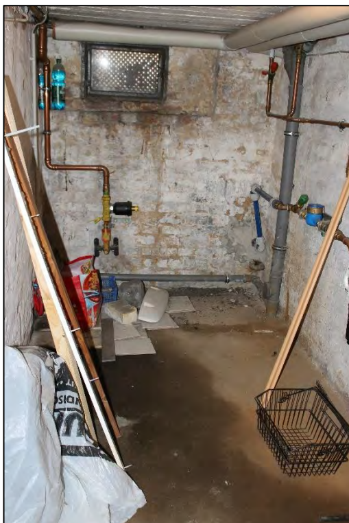
Foto Nr. 14: Kellergeschoss, Hausanschlussraum
