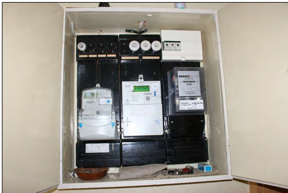
Foto Nr. 19: Erdgeschoss, Gemeinschaftstreppenhaus / Elektrounterverteilung
