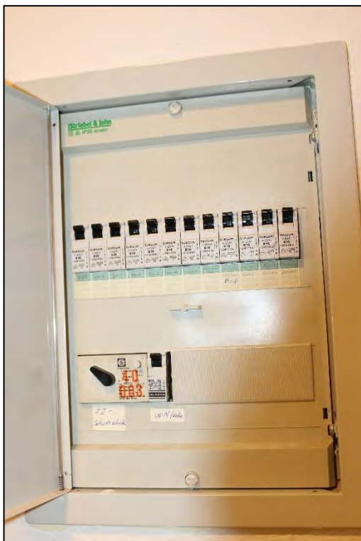
Foto Nr. 22: Erdgeschoss, WE Nr. 1, Diele, Elektroverteilung
