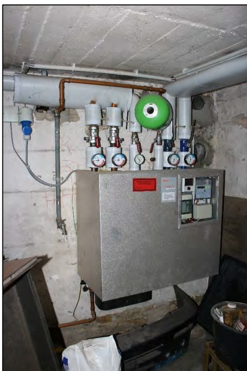
Foto Nr. 32: Kellergeschoss, Fernwärmeübergabestation
