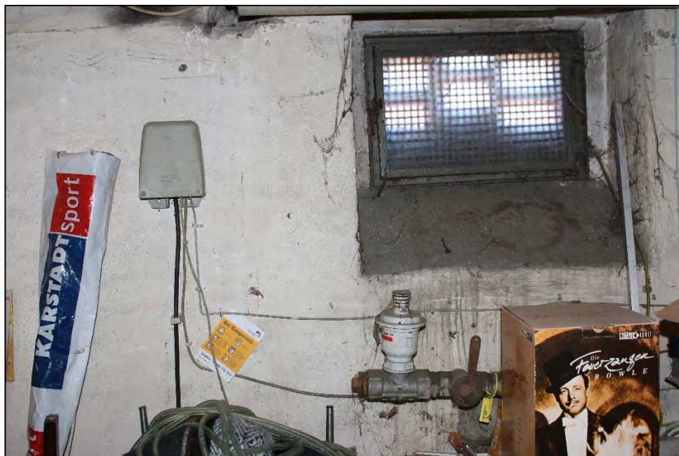
Foto Nr. 39: Kellergeschoss, Gashausanschluss
