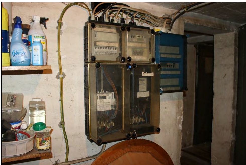
Foto Nr. 38: Kellergeschoss, Elektrounterverteilung
