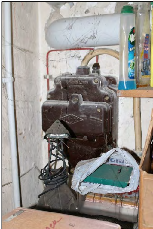
Foto Nr. 37: Kellergeschoss, Stromhausanschluss
