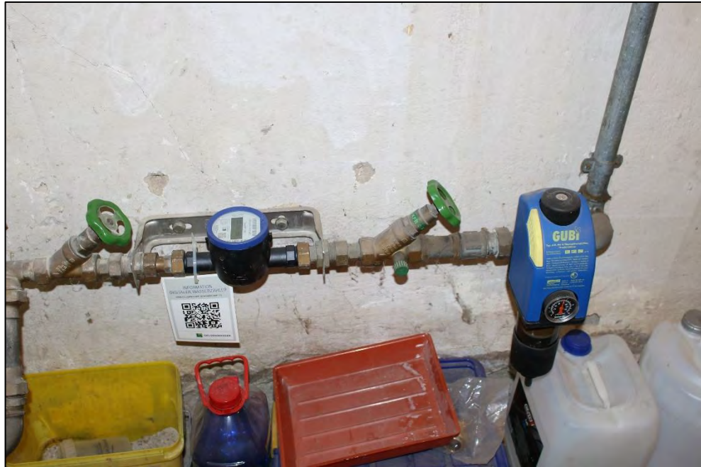
Foto Nr. 29: Kellergeschoss, Wasserhausanschluss
