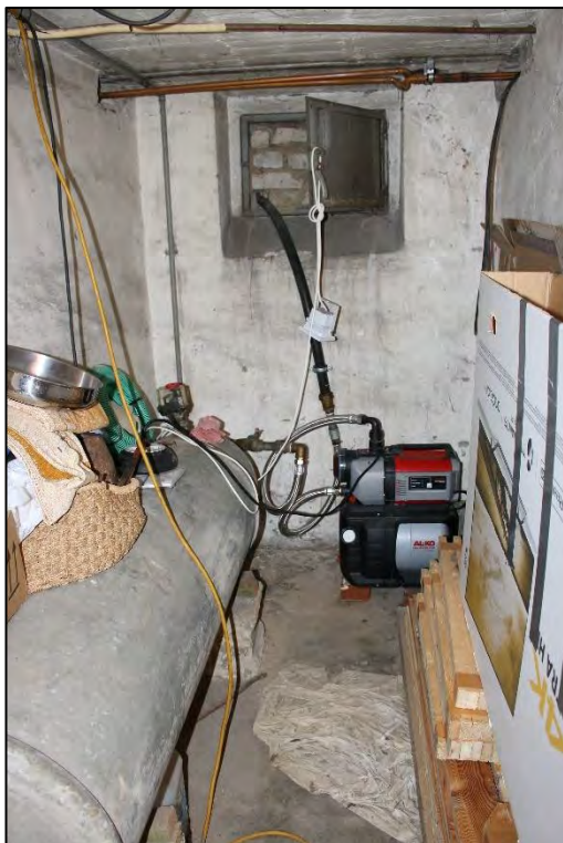
Foto Nr. 33: Kellergeschoss, Hauswasserwerk
