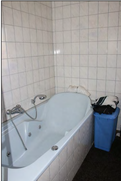
Foto Nr. 45: Erdgeschoss, WE Nr. 1, Bad
