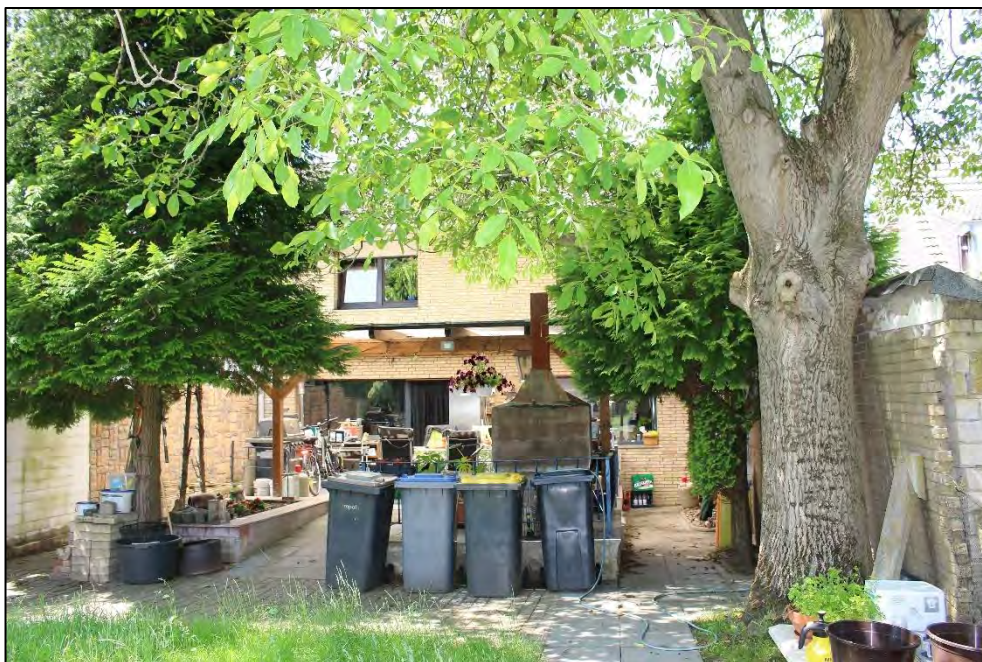
Foto Nr. 9: Gartenfassade / Terrasse / Garagengebäude (Schäden Verblendung)
