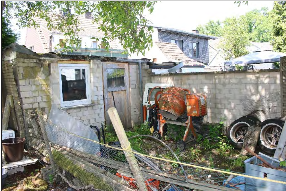
Foto Nr. 21: Garage / Rückseite / Schäden Dachanschlüsse / Verblendung
