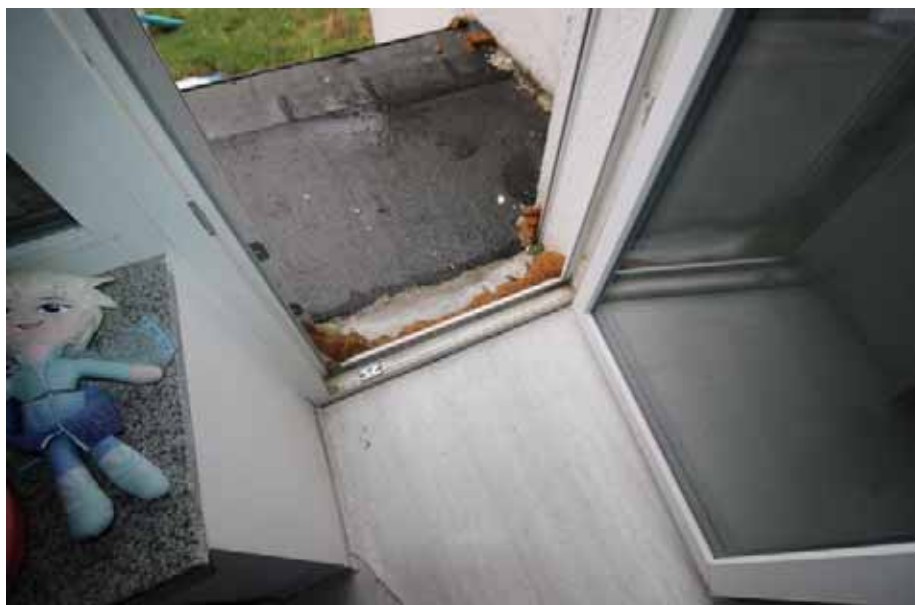
Sicht auf die Tür- schwelle von einem Raum auf die Ter- rassenüberdachung / OG links
