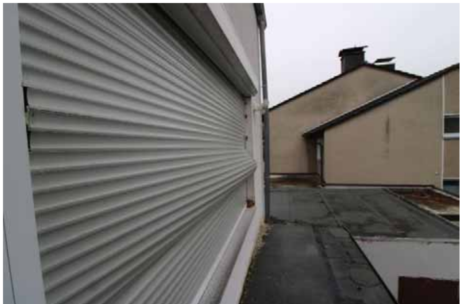
Sicht auf den fachgerecht instand zu setzenden Rollladen / OG links
