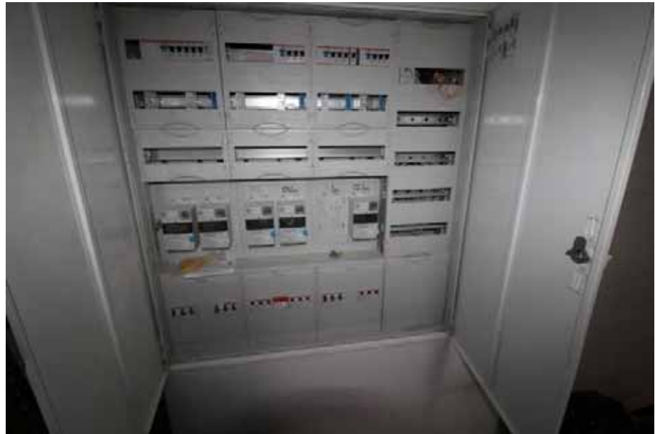
Sicht in den Zähler- und Sicherungskasten im Treppenhaus / EG
