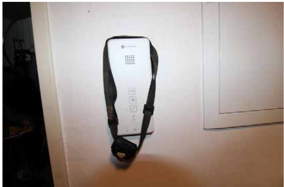
Sicht auf die Gegen- sprechanlage / EG rechts
