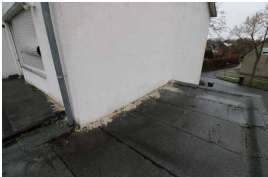
Sicht auf den fachgerecht instand zu setzenden Fassadenanschluss zur Pkw-Garage und Terrassenüberdachung / OG links
