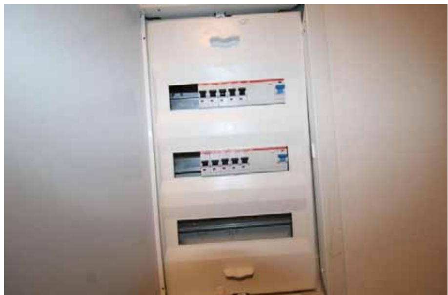
Sicht in den Siche- rungskasten / EG rechts
