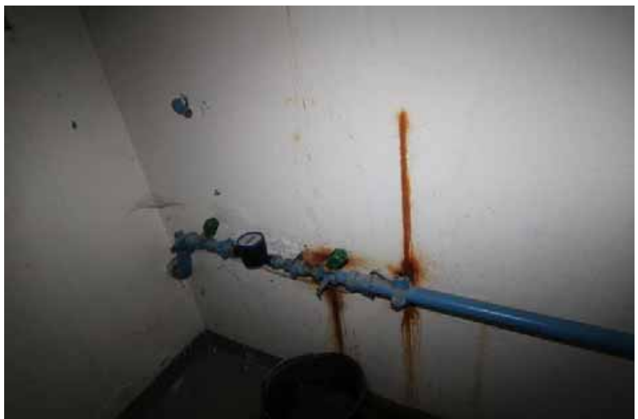
Sicht auf den Wasseranschluss im Heizungskeller / KG
