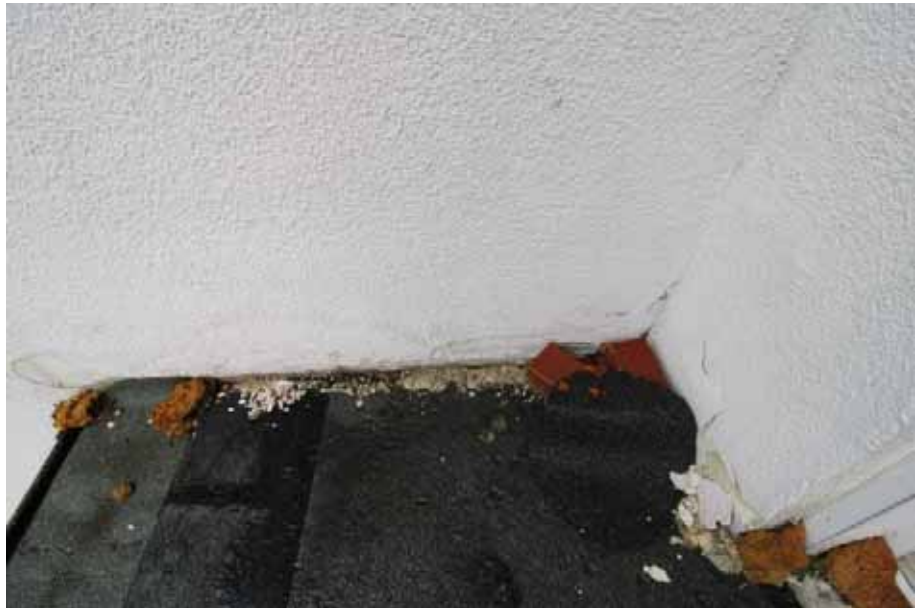
Sicht auf den fachgerecht instand zu setzenden Fassadenanschluss zur Pkw-Garage und Terrassenüberdachung / OG links
