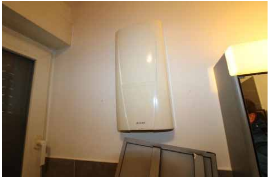
Sicht auf den Durch- lauferhitzer im Bad / EG rechts
