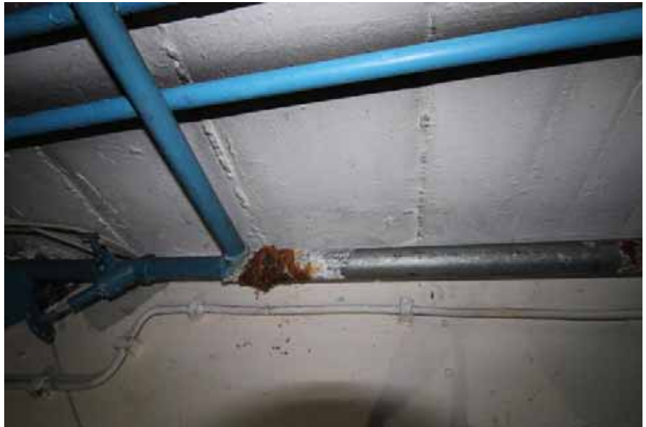
Sicht auf die korrodierten Leitungen im Heizungskeller / KG
