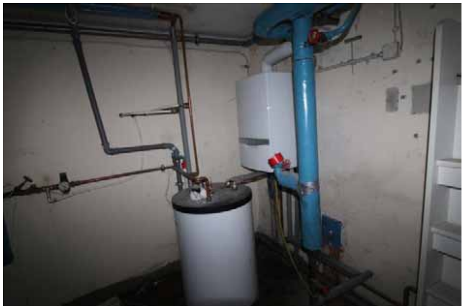
Sicht auf die Heizung / KG
