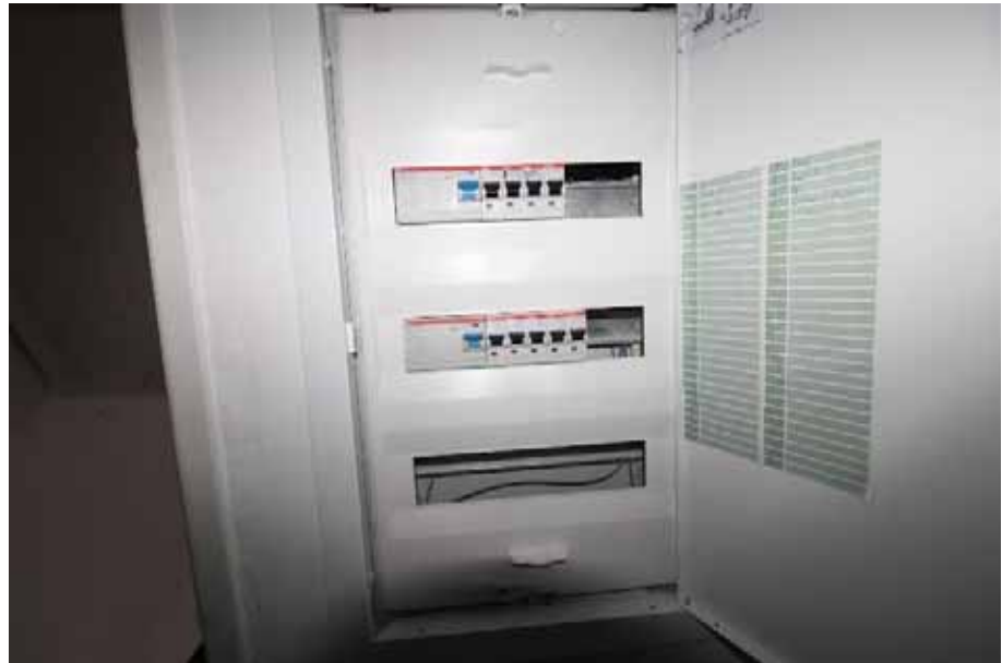
Sicht in den Sicherungskasten / OG links
