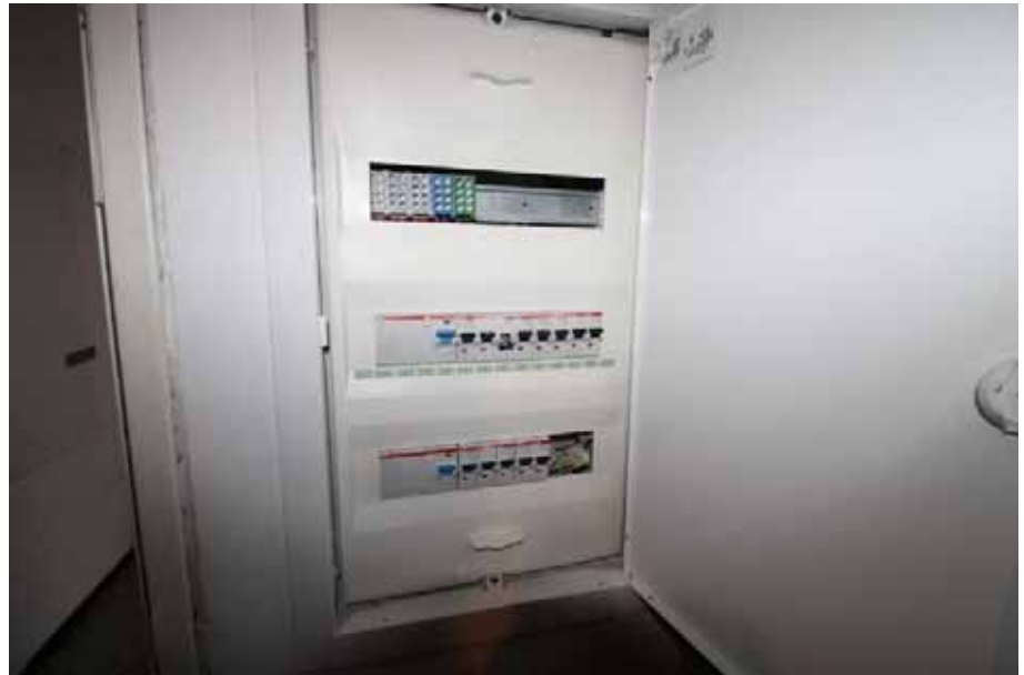
Sicht in den Sicherungskasten / EG links
