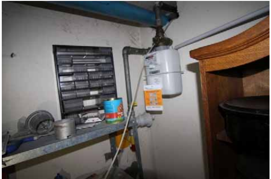
Sicht auf den Gasanschluss in einem Kellerraum / KG
