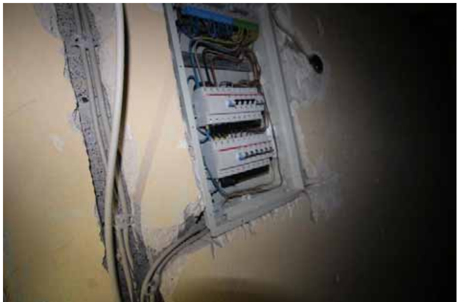
Sicht auf einen Sicherungskasten in einem Kellerraum / KG
