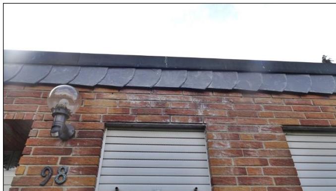
4) Detailfoto Fassade/ Ausblühungen Klinker
