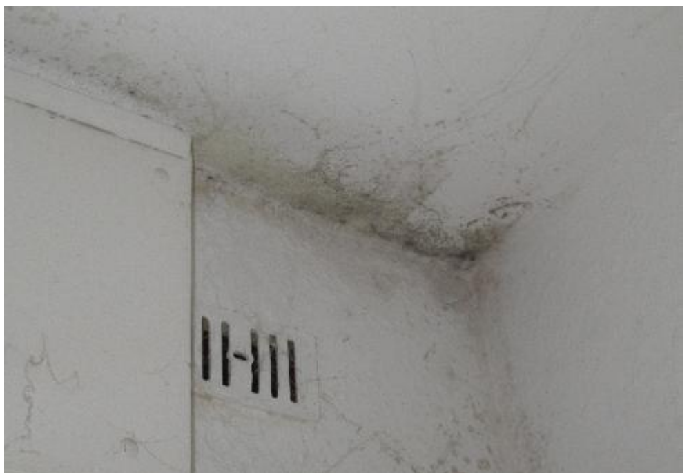
Durchfeuchtung/Schimmelbildung in der Küche
