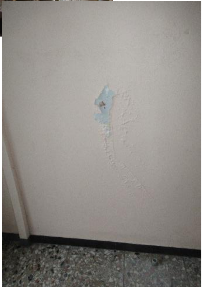
Putzschäden im Treppenhaus
