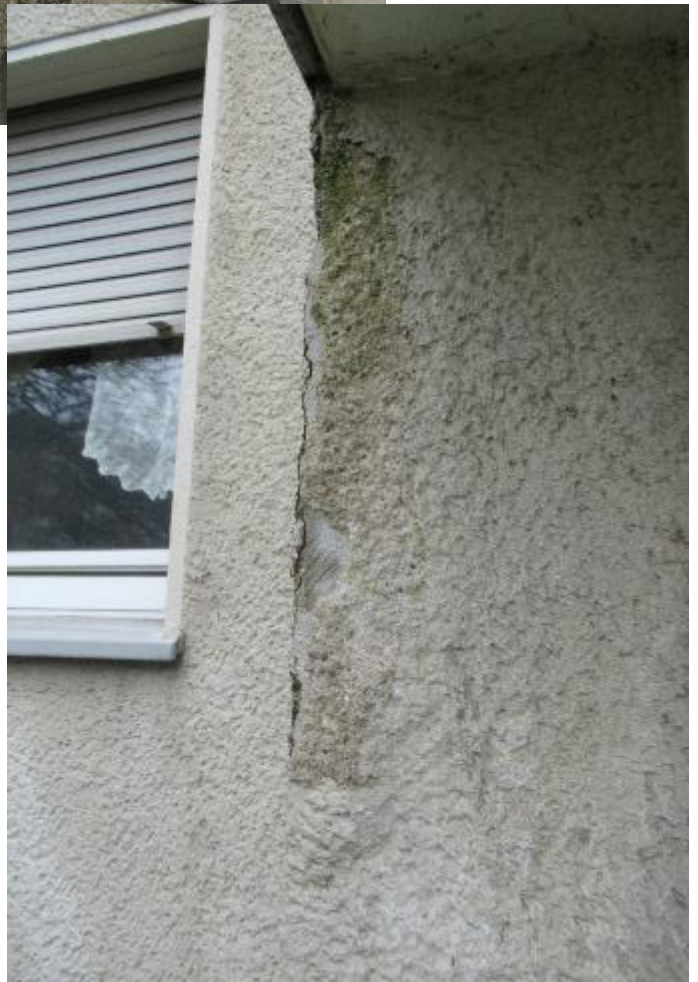
Risse und Durchfeuchtungen an der Straßenfassade
