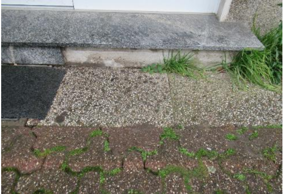
fehlende Platte an der Eingangsstufe
