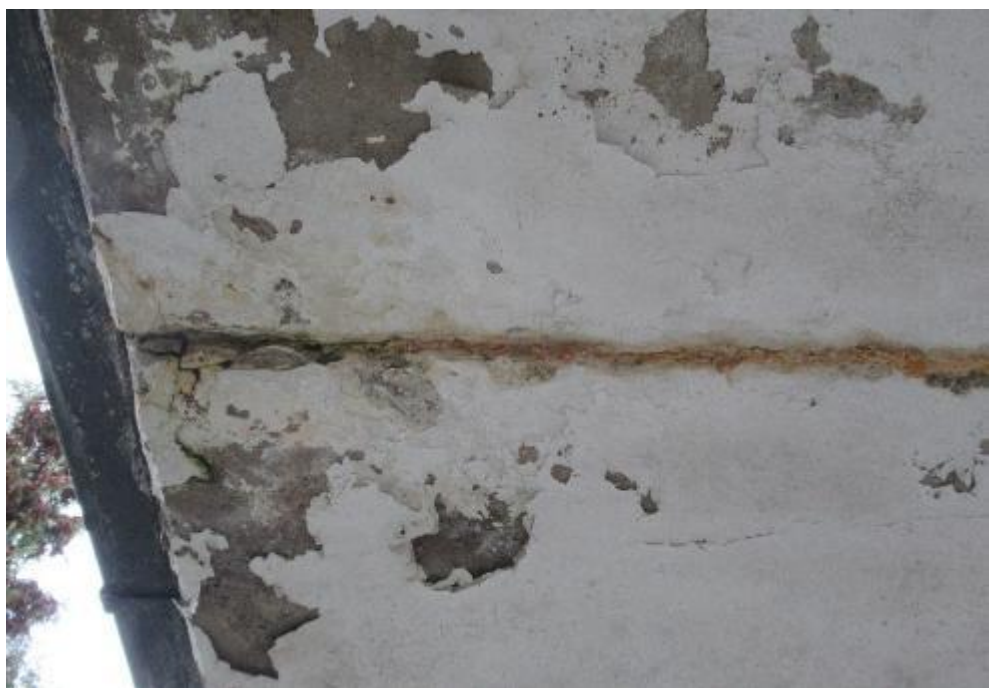
Schäden am Balkon
