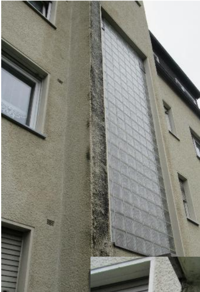
Durchfeuchtungen an der Straßenfassade
