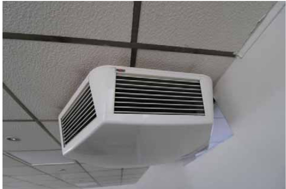
Sicht auf einen Luft- heizer im Ausstel- lungsraum / EG rechts
