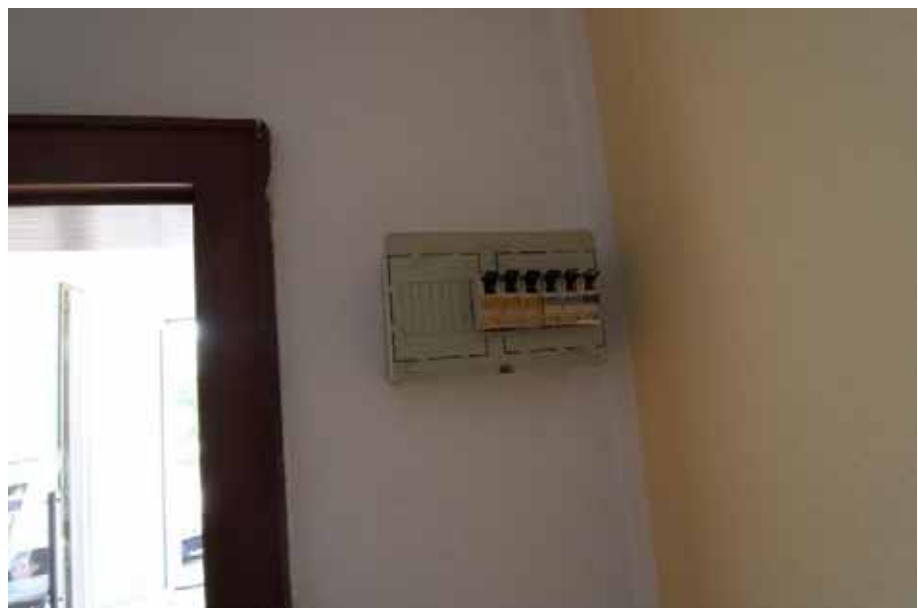
Sicht auf einen Sicherungskasten / OG
