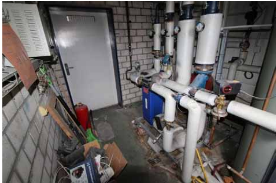
Sicht in den Heizungsraum Fernwärmeübergabe / EG links
