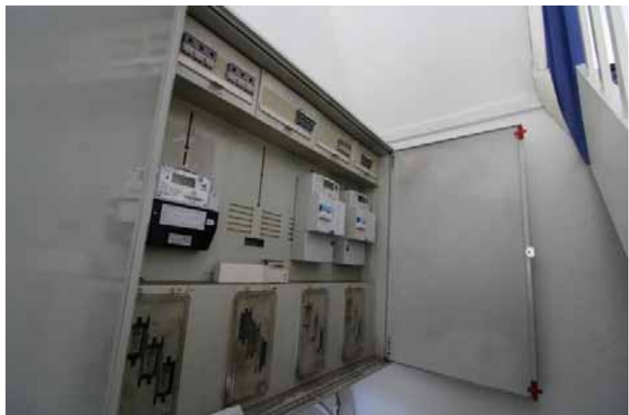
Sicht in einen Sicherungs- und Zählerkasten im Flur / EG
