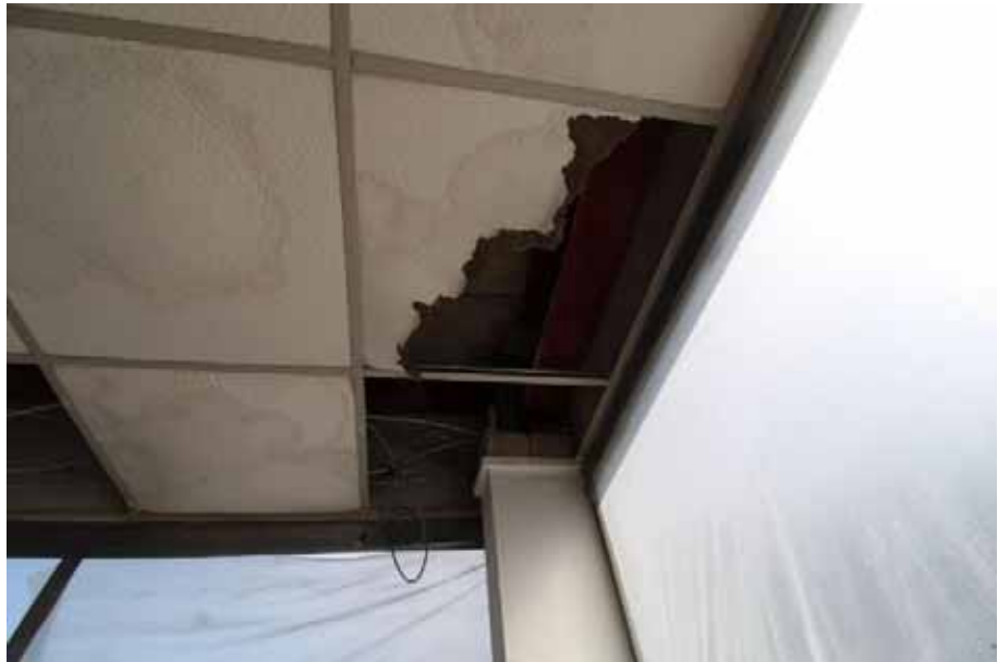
Sicht auf die beschädigte Akustikplatten- decke in dem Raum 1 / EG rechts
