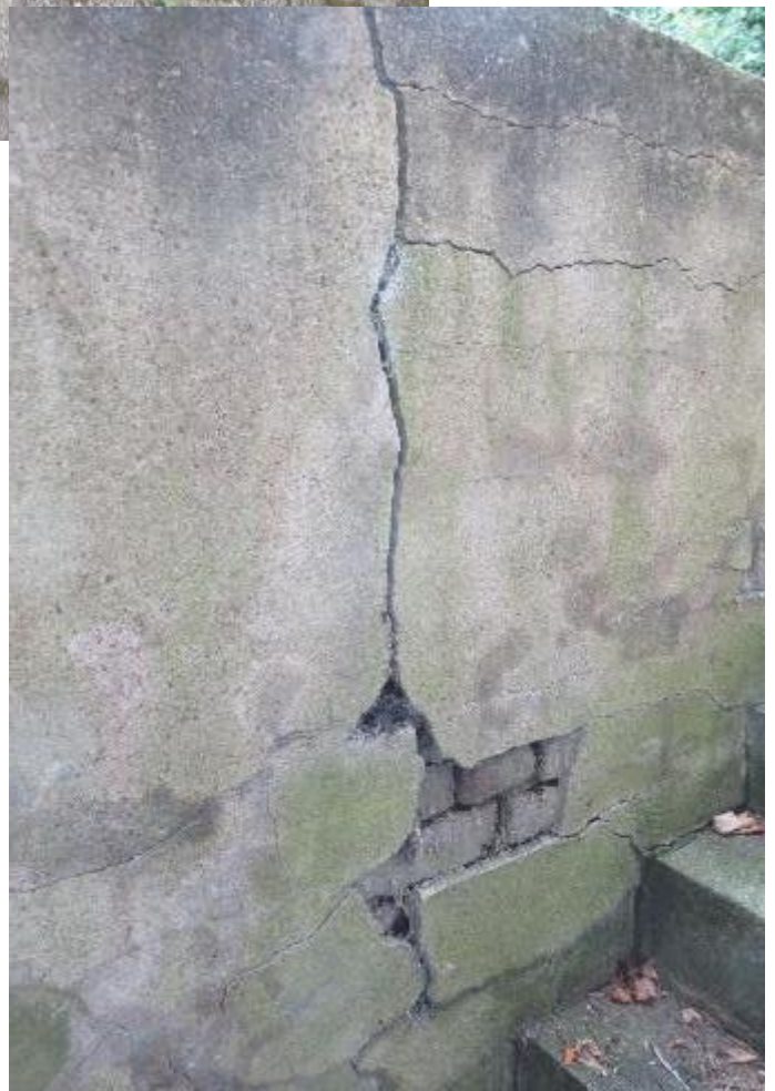
Risse und Putzabplatzungen am Kellerabgang
