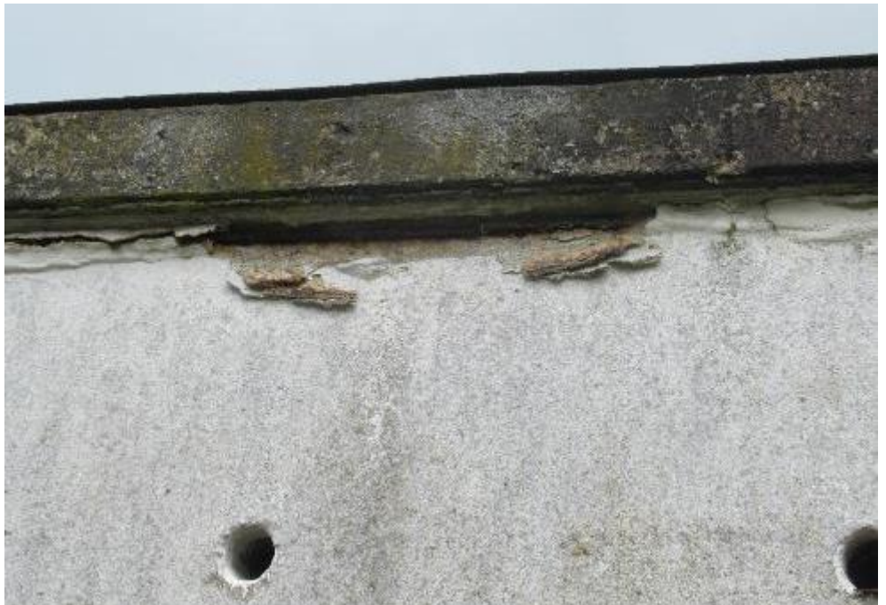
Schäden an den Garagen
