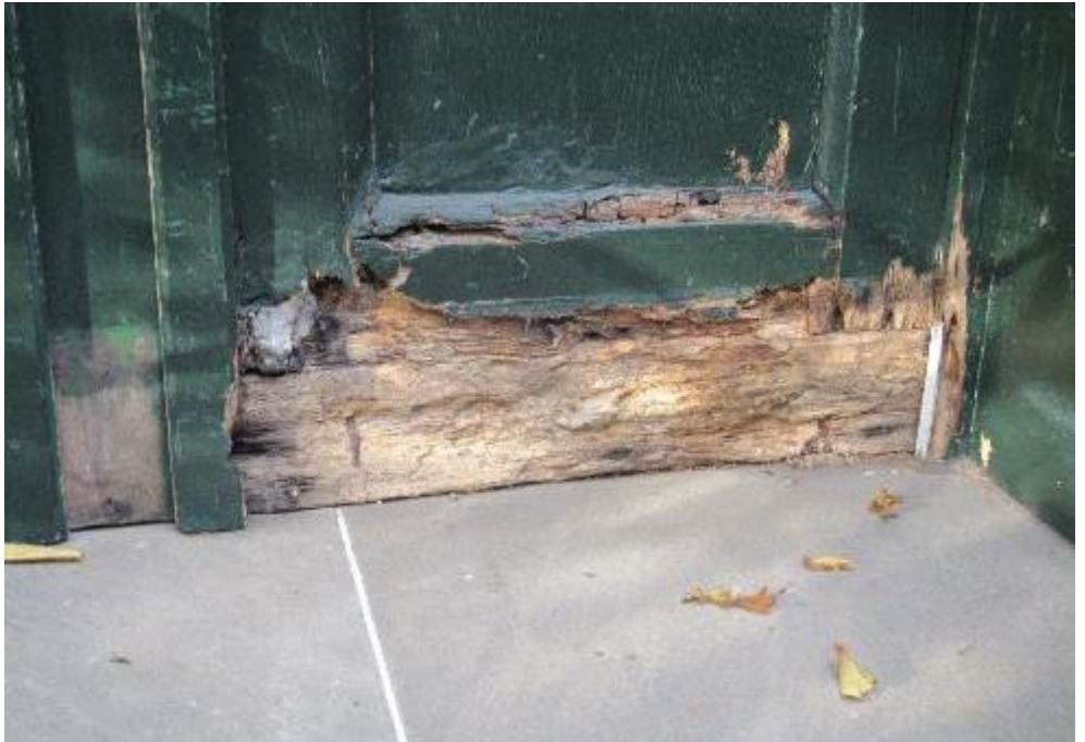
Schaden an Haustür
