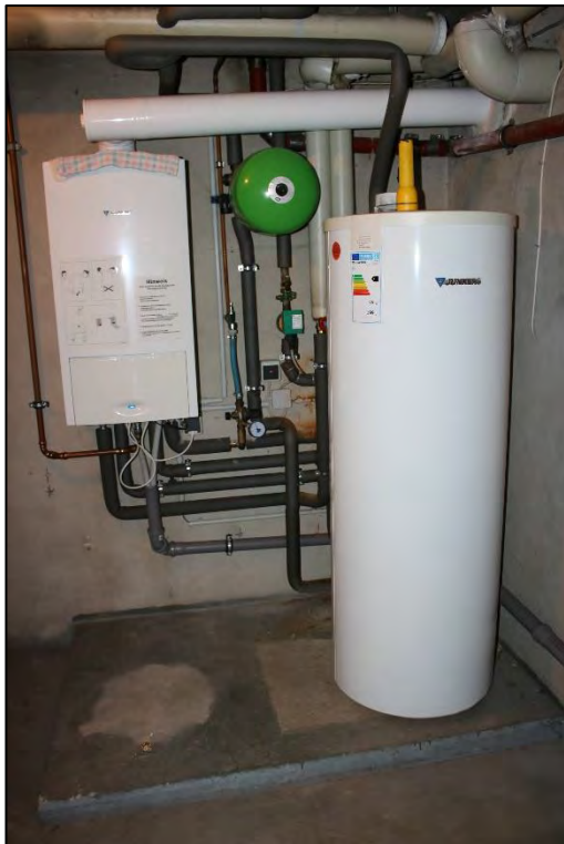
Foto Nr. 39: Einfamilienreihenendhaus, Kellergeschoss, Heizungsraum
