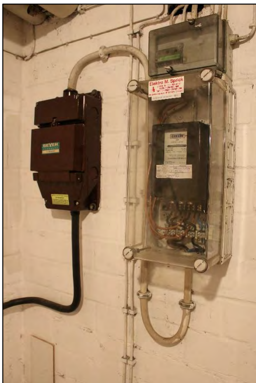
Foto Nr. 38: Einfamilienreihenendhaus, Kellergeschoss, Stromhausanschluss
