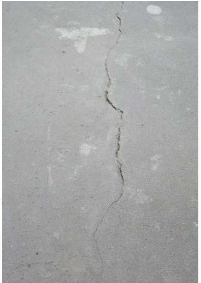
Riss im Fußboden
