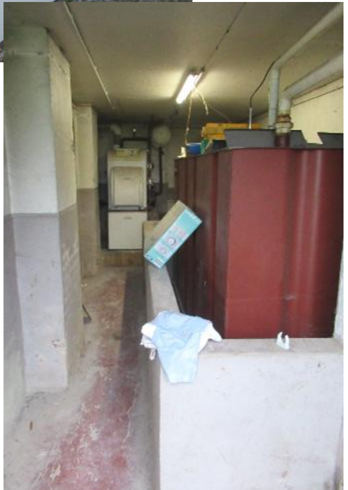
Öltank und Heizung
