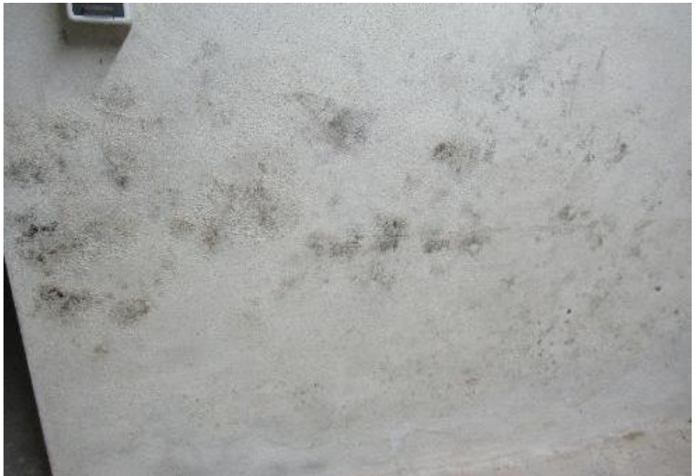
Schimmelbildung im Wandbereich
