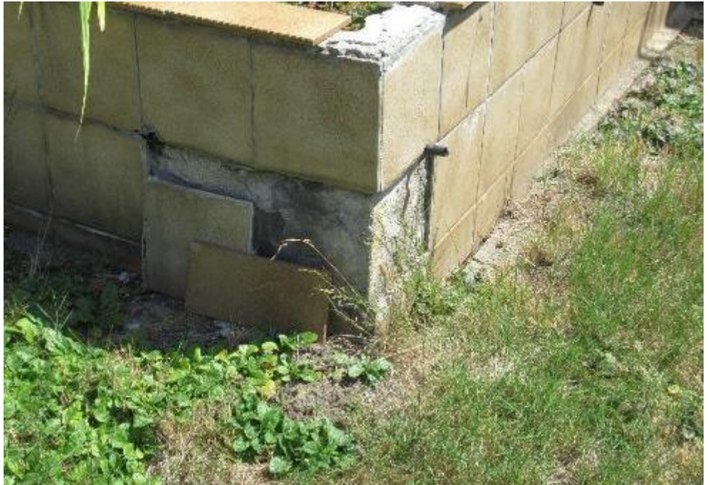
Schäden an der Terrasse
