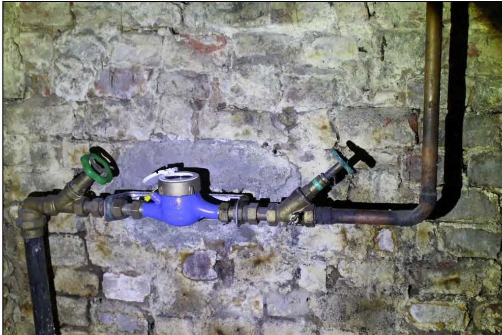
Foto Nr. 67: Kellergeschoss, Wasserhausanschluss
