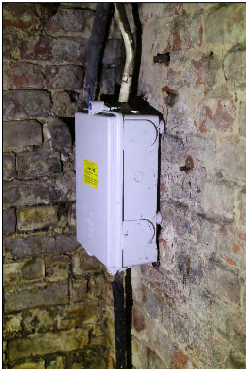
Foto Nr. 68: Kellergeschoss, Stromhausanschluss
