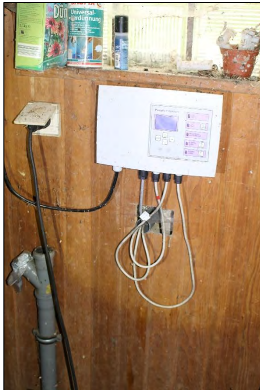
Foto Nr. 53: Kellergeschoss, Waschküche / Steuerung Hebeanlage
