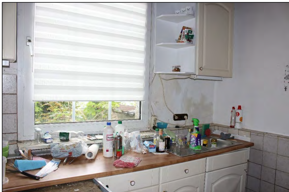
Foto Nr. 20: Erdgeschoss, Küche / Feuchteschäden
