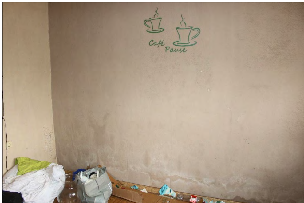
Foto Nr. 18: Erdgeschoss, Esszimmer / Feuchteschäden
