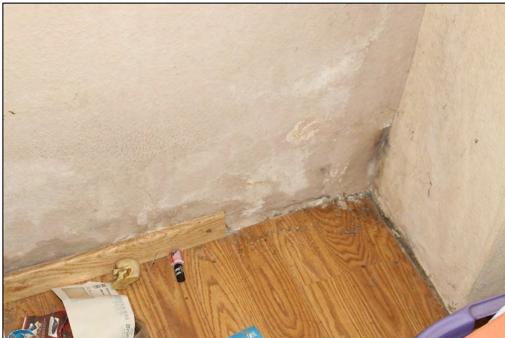
Foto Nr. 16: Erdgeschoss, Esszimmer / Feuchteschäden
