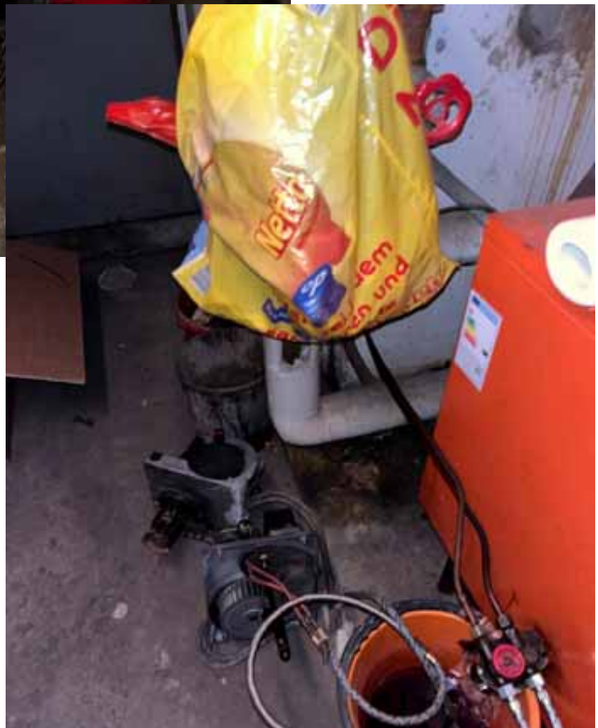
Wärmeerzeugungsanlage mit undichter Energiezufuhr
