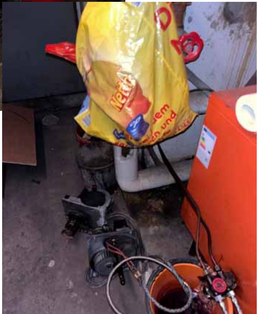
Wärmeerzeugungsanlage mit undichter Energiezufuhr
