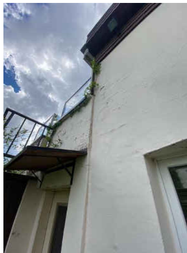
Putzschäden an Fassade
