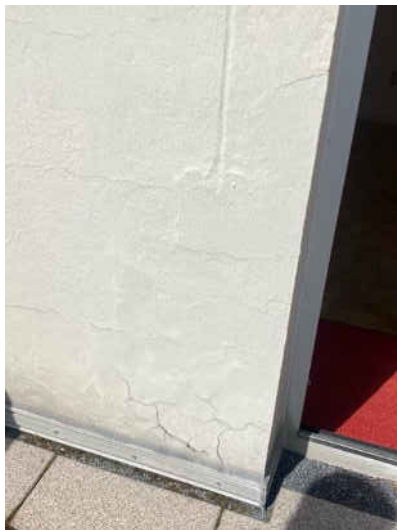
Putzschäden an Fassade
