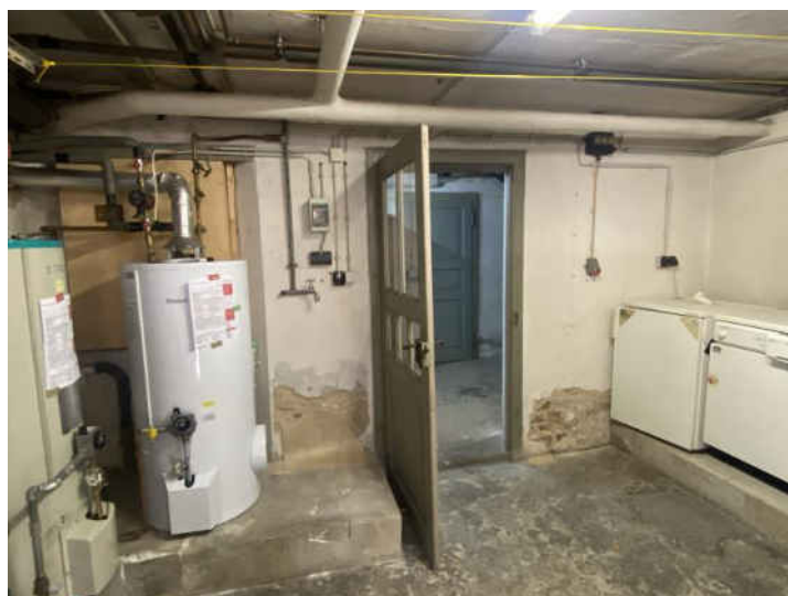
Wasserkessel und Feuchteschäden
