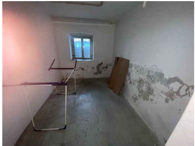
Putz- und Anstrichschäden im Kellergeschoss
