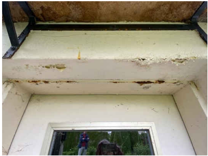
Putz- und Korrosionsschäden 2. Eingang Anbau
