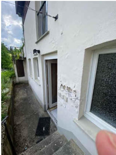
Eingangssituation Anbau mit Feuchteschäden
