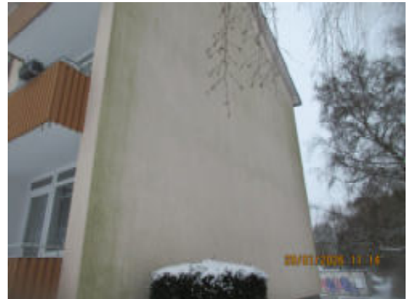
Nordfassade mit Algenansatz und Moosbildung
