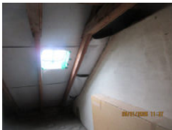
Tür zum Dachboden nicht abdichtet
