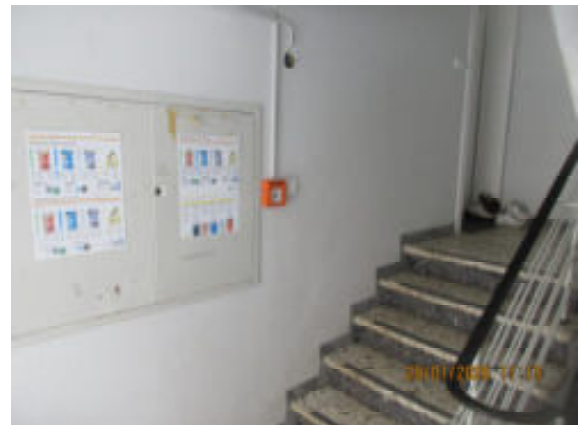
Treppe zum EG/ fehlende Abdeckung
