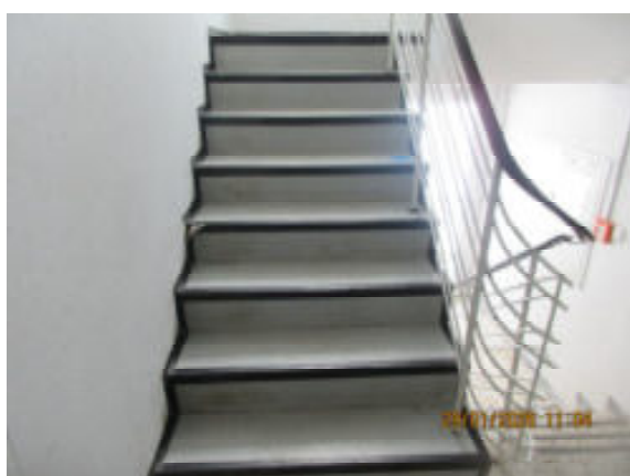
Treppe zum OG /DG /schadhafter Belag Detail schadhafter Treppenbelag
