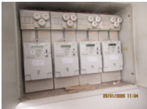
Zählerkasten mit Schraubsicherungen
