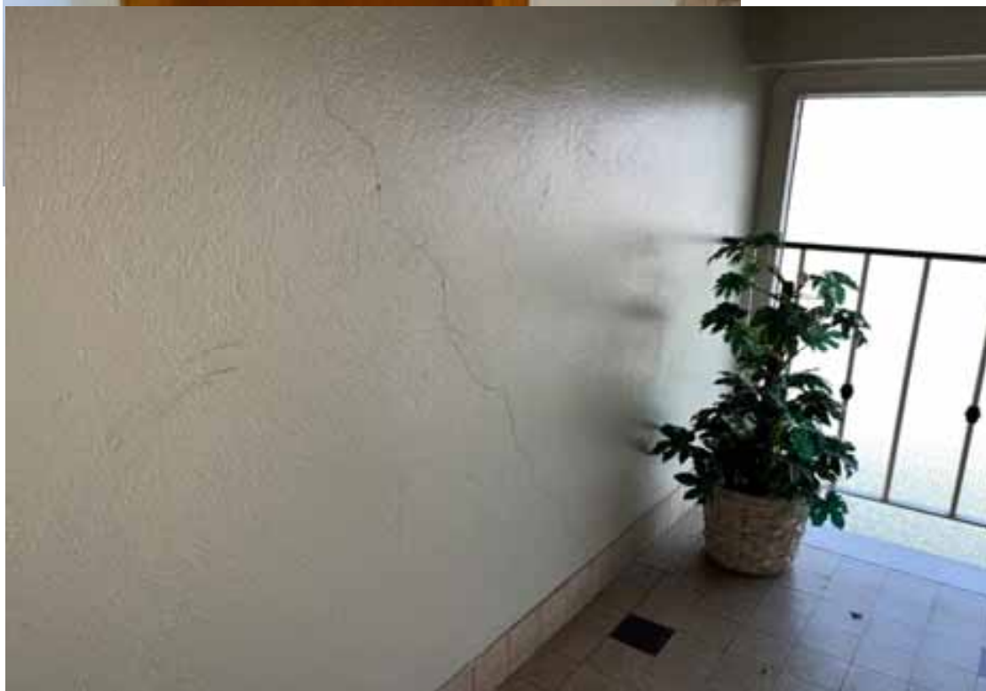
Leichte Wandrisse im Treppenhaus
