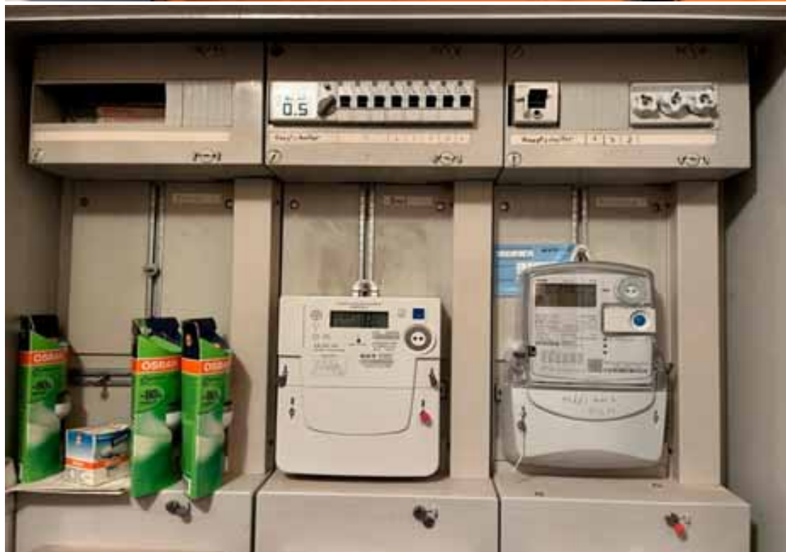
Energielager (Stahltanks für Heizöl) Elektrische Hauptverteilung
