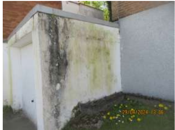
Feuchteeinwirkung Algenbildung /Fassade der Garage
