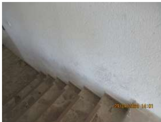
Feuchtespuren im unteren Wandbereich
