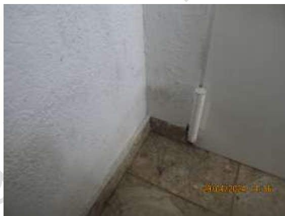
Detail Feuchte im Treppenhaus / Kellerflur
