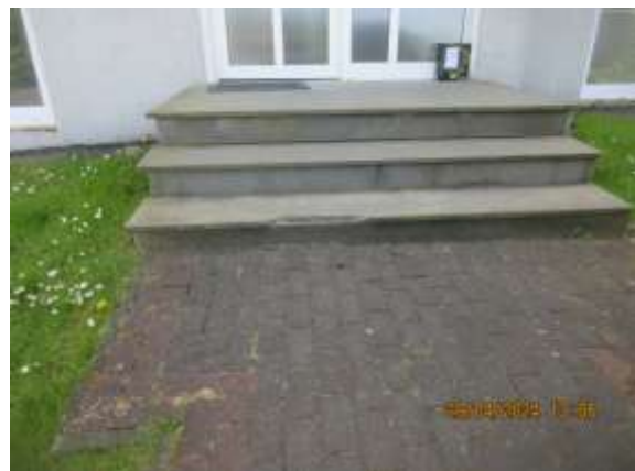
Hauseingangstreppe – Stufe / schadhaft
