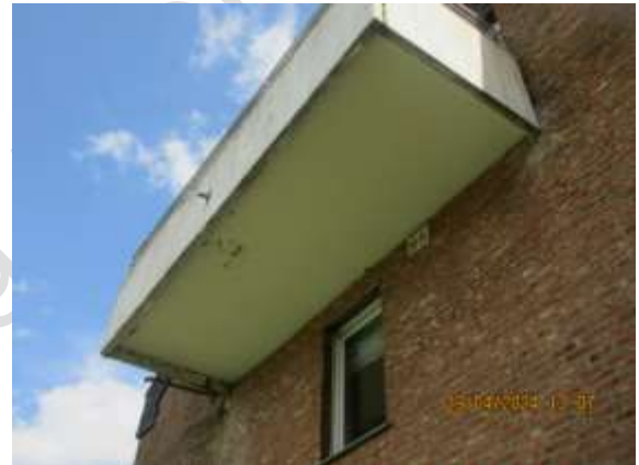
Balkon im Nordwesten / schadhaft
