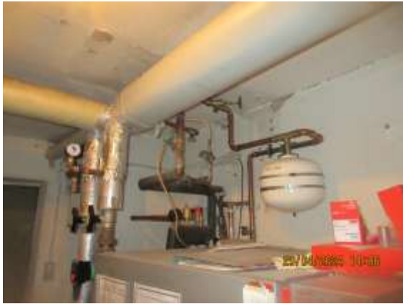
Heizungsanlage / gedämmte Leitungen
