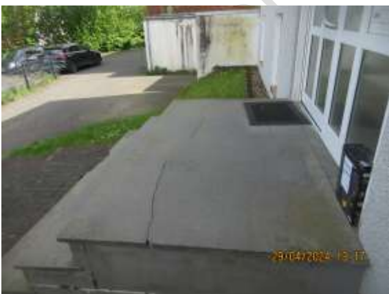
Hauseingangstreppe - Podest / schadhaft
