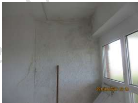
Detail Feuchteschaden an der Wand und unter Decke
