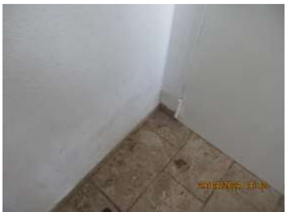
Feuchtespuren Treppenhaus /Kellerflur
