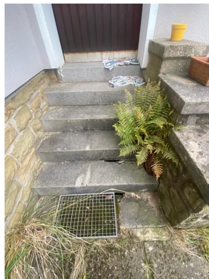
Hohlraumbildung unter Treppe
