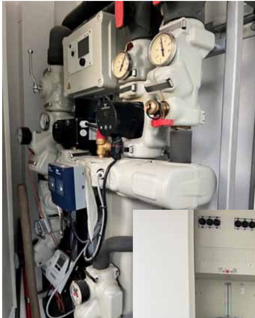
Wärmeübertragungsstation mit Nahwärmeanschluss
