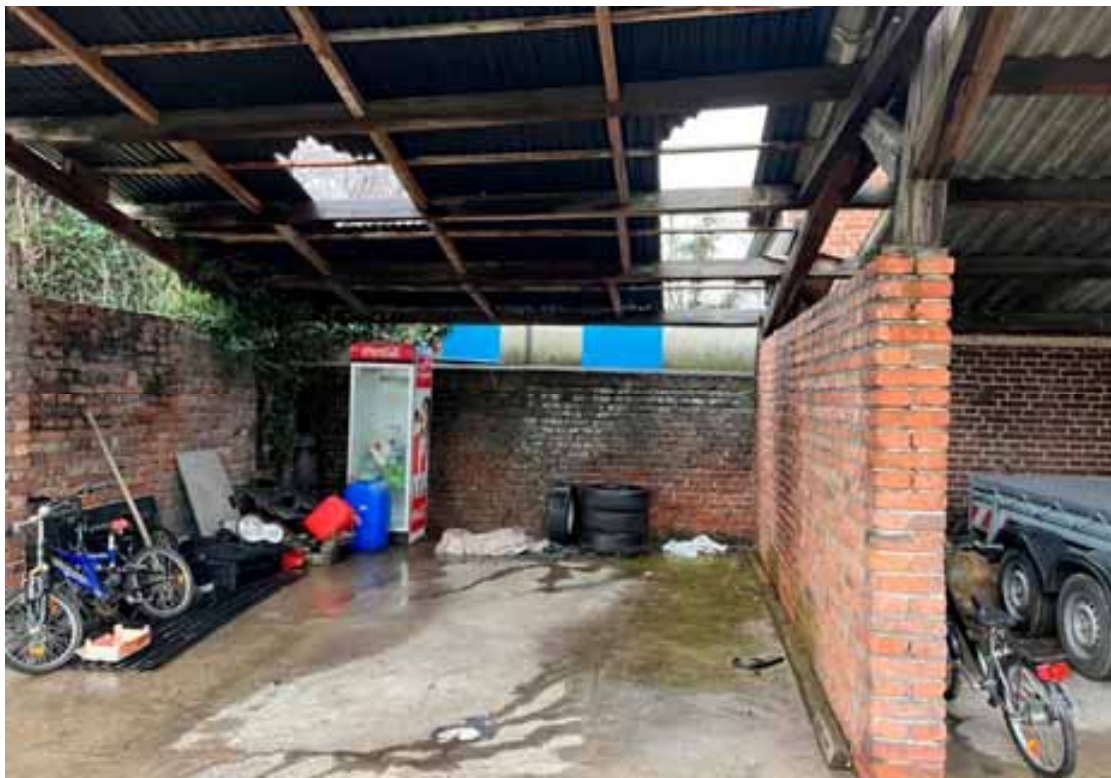
Innenhof und alte, baufällige Remise
