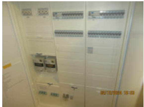
Zählerschrank mit Unterverteilungen
