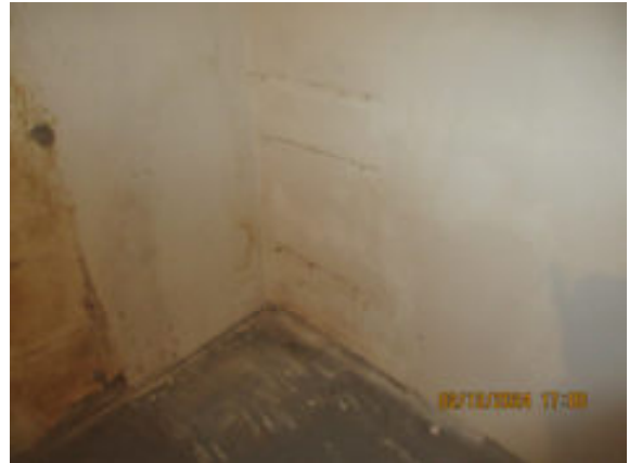
Feuchte im unteren Wandbereich
