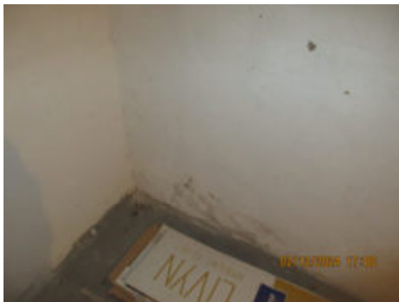
Feuchte im unteren Wandbereich
