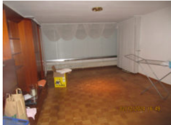
Wohnzimmer / schadhaftes Parkett
