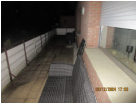
Bakon / schadhafter Belag
