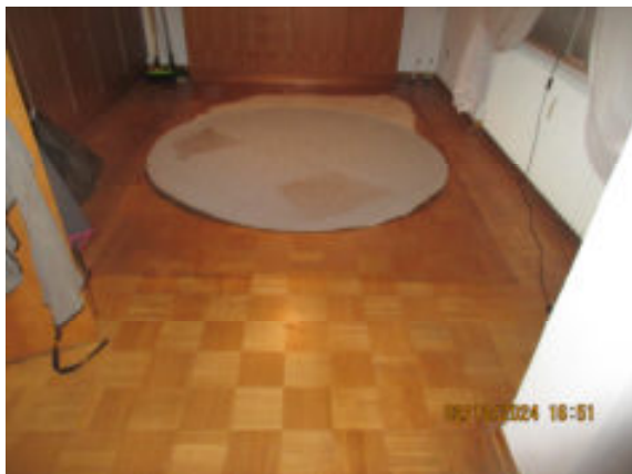
Parkett im Esszimmer / schadhaft
