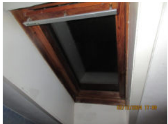
Dachflächenfenster mit Feuchteeinwirkung im Badezimmer
