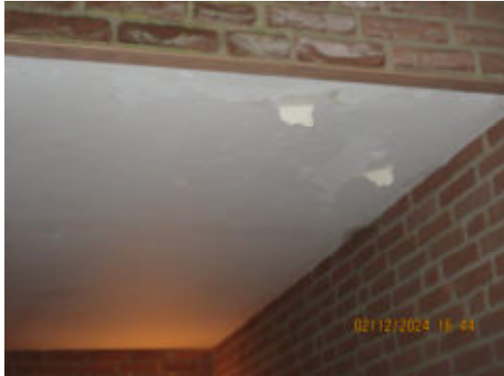
Überdachung zwischen garage und Wohnhaus Putz- und Anstrichschaden
