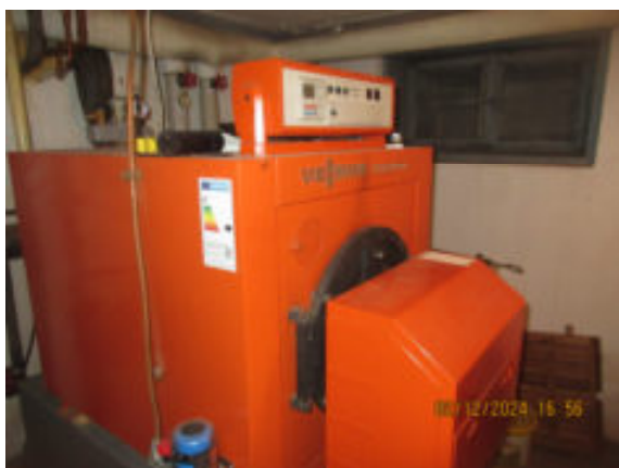
Heizungsanlage / Olkessel mit Warmwasserbereitung/- speicher
