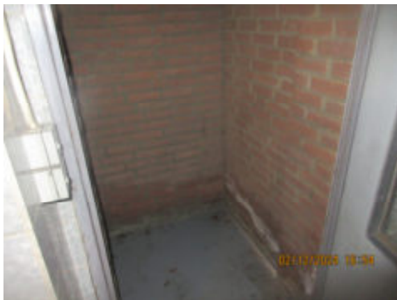
Kellerausgang zur Außentreppe / Feuchtebelastung
