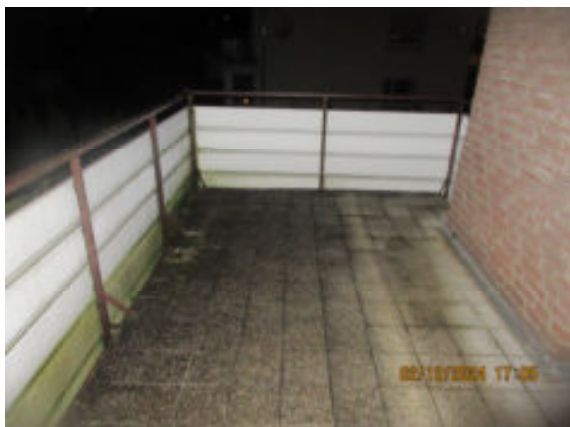
Schadhafter Fliesenbelag / schadhaftes Geländer
