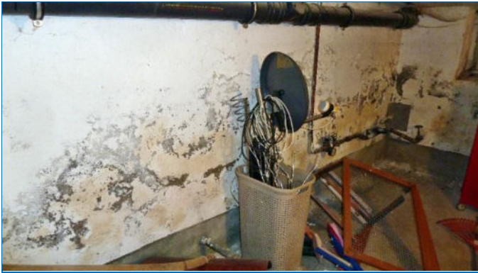
-10- Feuchtespuren an Kellerwand
