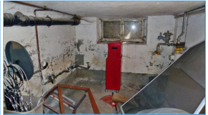
-11- Feuchtespuren an Kellerwand
