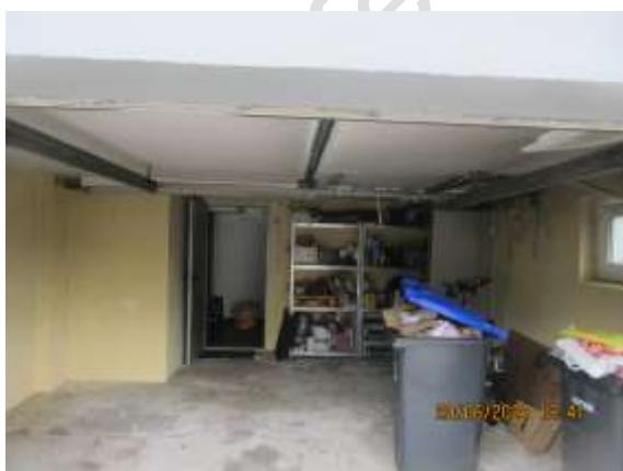
Garage / schadhafter Fußboden
