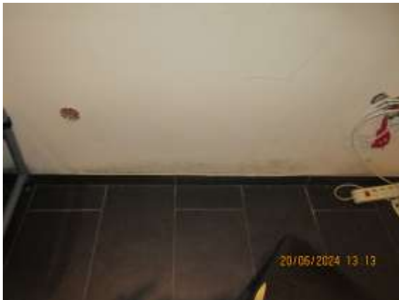
Feuchte im bodennahen Bereich
