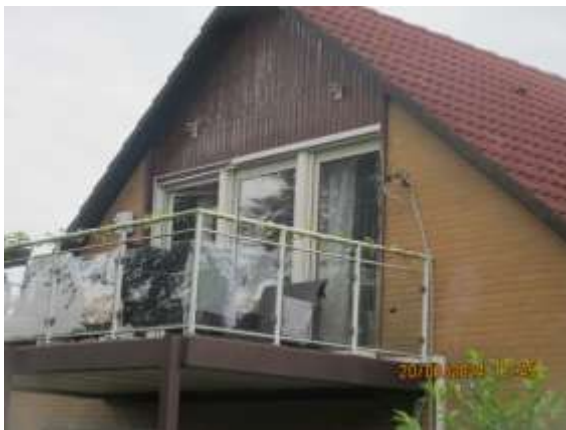
Giebel im NW / schadhafter Holzanstrich
